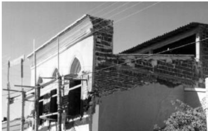
Fig.59b - Detalhe do edifício à rua 7 de setembro – consequência da imposição do risco.
