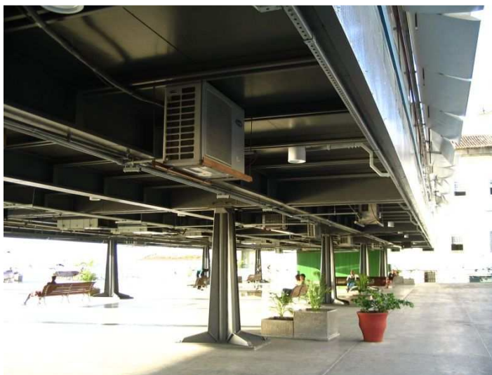
Fig.60: Estrutura pintada e aparelhos instalados fora do projeto
