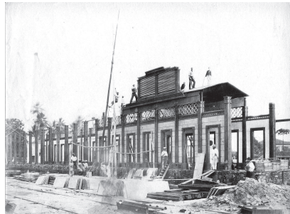
Figura 4 - Estação da Calçada, vista do seu interior, início da construção. Montagem de estrutura em ferro e de painéis de vedação. Foto de Benjamin Mulock, 8 de agosto de 1860. Fonte: Acervo do Institution of Civil Engineers London.
