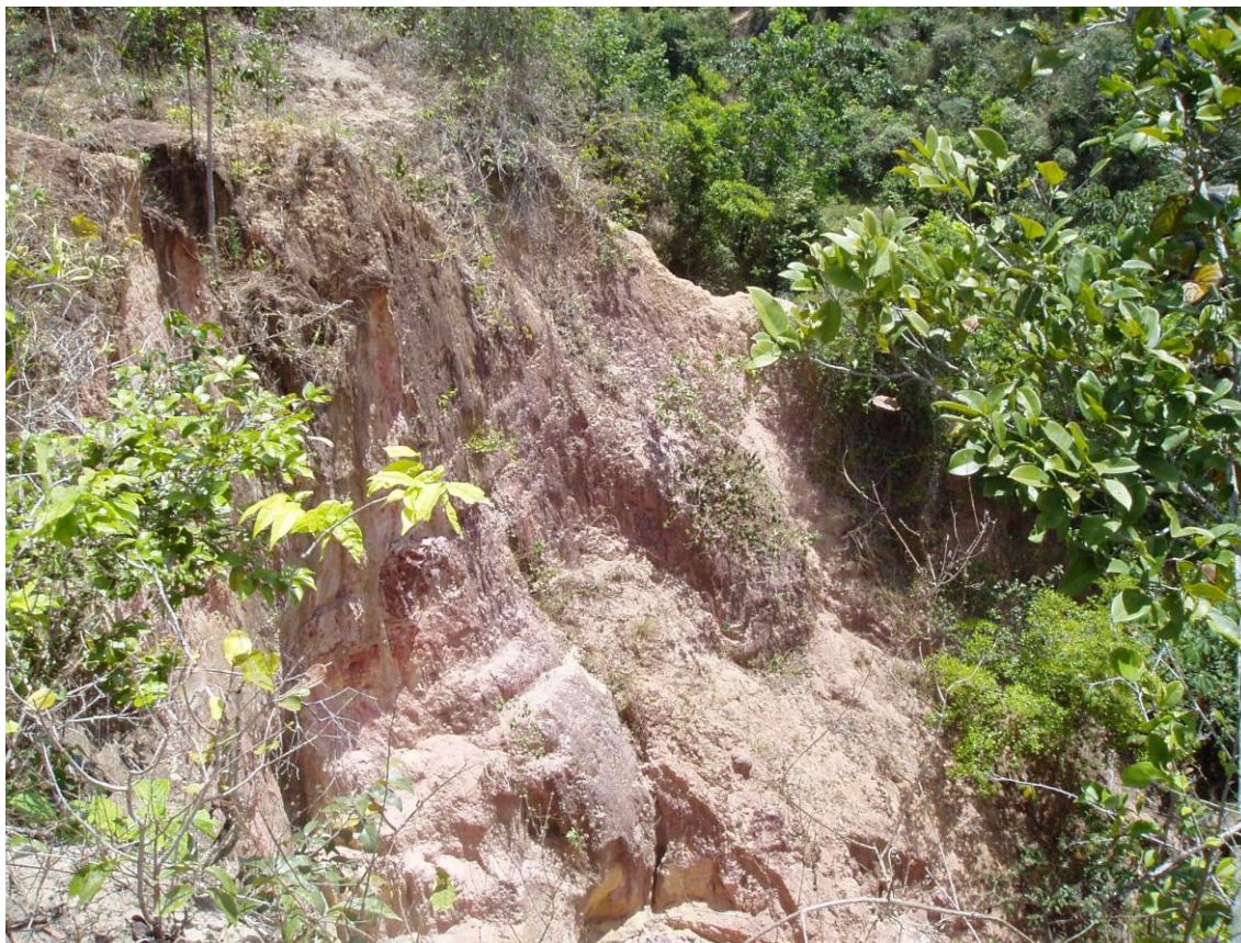
Figura 4.23: Erosão na encosta do vale
