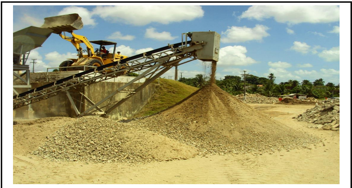
Figura 2.17: Esteira transportadora com enchedeira (interior da USIBEN) Fonte: Autor da pesquisa. (jun/2009).
