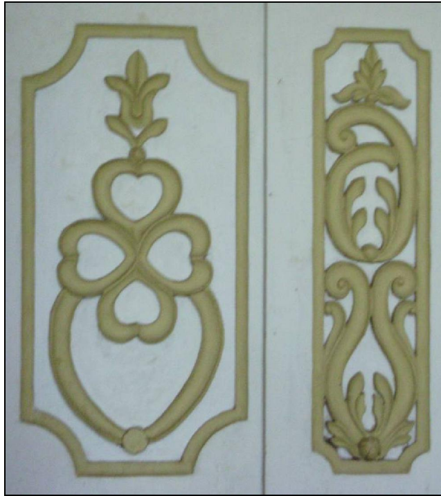
Figura 18: Detalhe dos ornatos do altar-mor da Igreja de São Benedito Fonte: Roberta Bacellar Orazem, outubro de 2007
