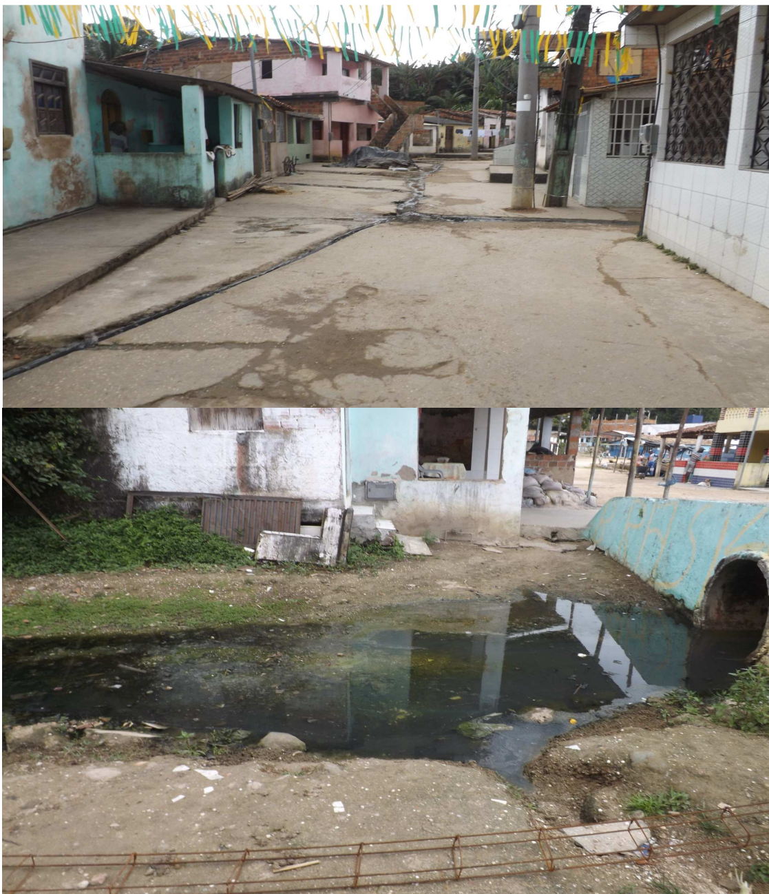
Figura 12 – Esgotos a céu aberto na Rua do Beco, Praia Grande, Ilha de Maré, Salvador-BA. Agosto, 2014.
