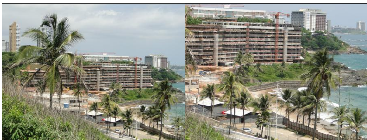
Figura 29. Registro da construção do edifício Costa España, Salvador – BA, 10/12/ 2011. Fonte: Pesquisa de tese da autora,
