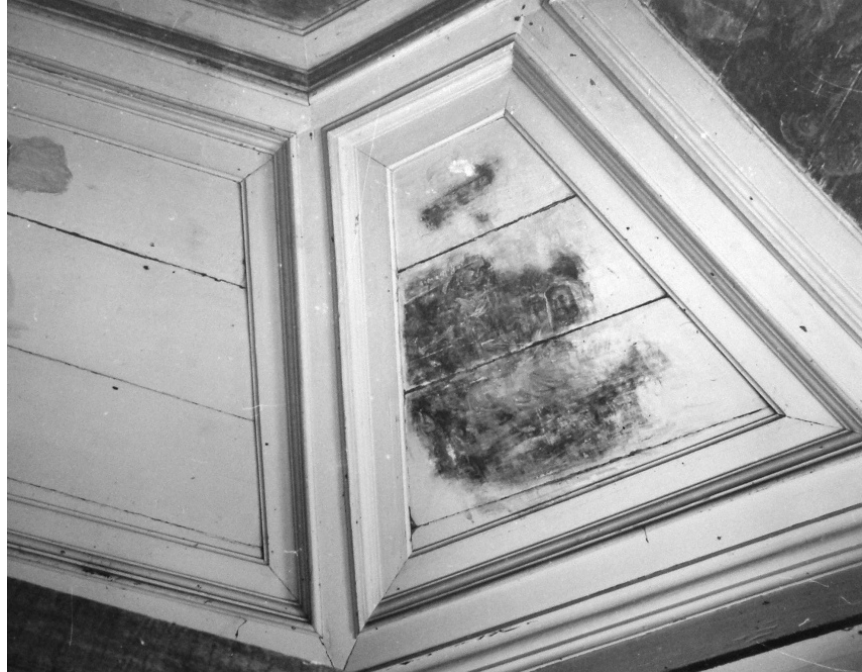
Figura 50 - Teste de limpeza no forro da sala do Prior
