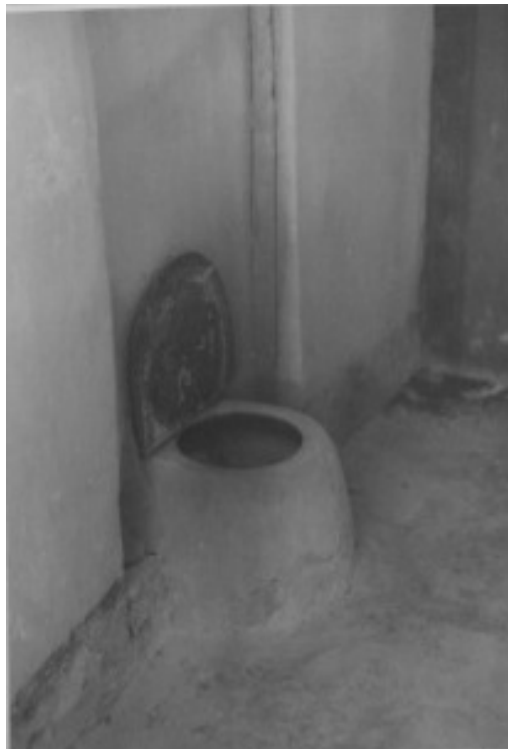
Sanitário em uso até o início das obras em 1958. Fonte: Arquivo Histórico do MAS – UFBA.
