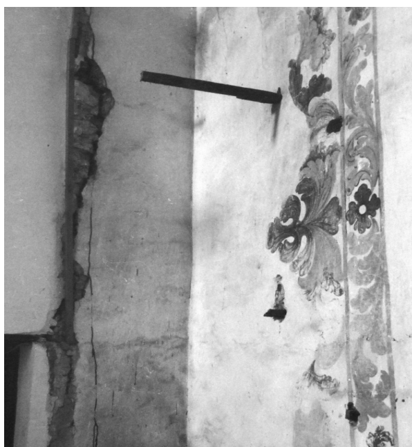
Figura 46 – Detalhe da pintura à têmpera, na parede que recebe o Altar do Transepto.
