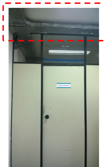
Figura 54 - Canaletas metálicas e luminárias no teto do setor de Neurociências Fonte: Arquivo pessoal da autora
