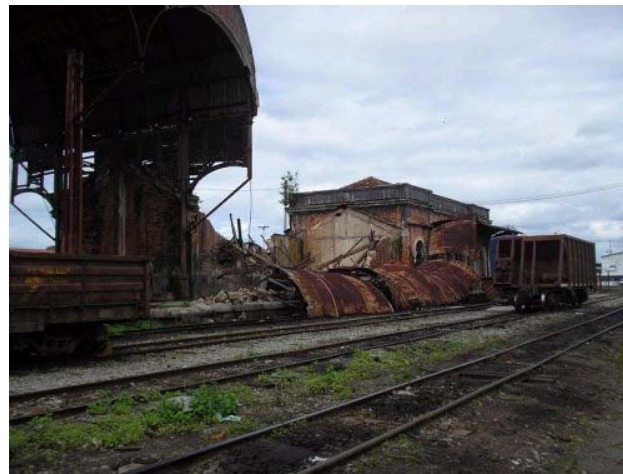
Figura 14 ESTADO DE CONSERVAÇÃO DA ESTAÇÃO DE SÃO FRANCISCO – 2006
