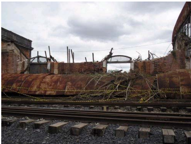
Figura 13 ESTADO DE CONSERVAÇÃO DA ESTAÇÃO DE SÃO FRANCISCO – 2006
