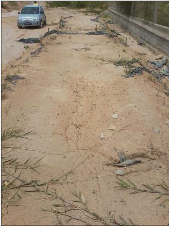
Figura 6. 7: Trincas que surgiram no aterro de mistura 1. Fotos tiradas no mês de outubro de 2013
