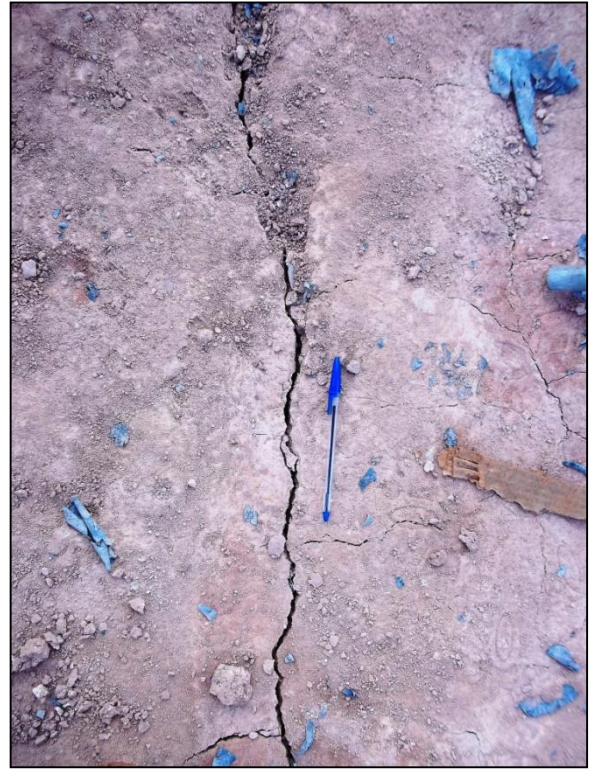
Figura 6. 8: Em evidência uma trinca no aterro de mistura 1. Fotos tiradas no mês de outubro de 2013
