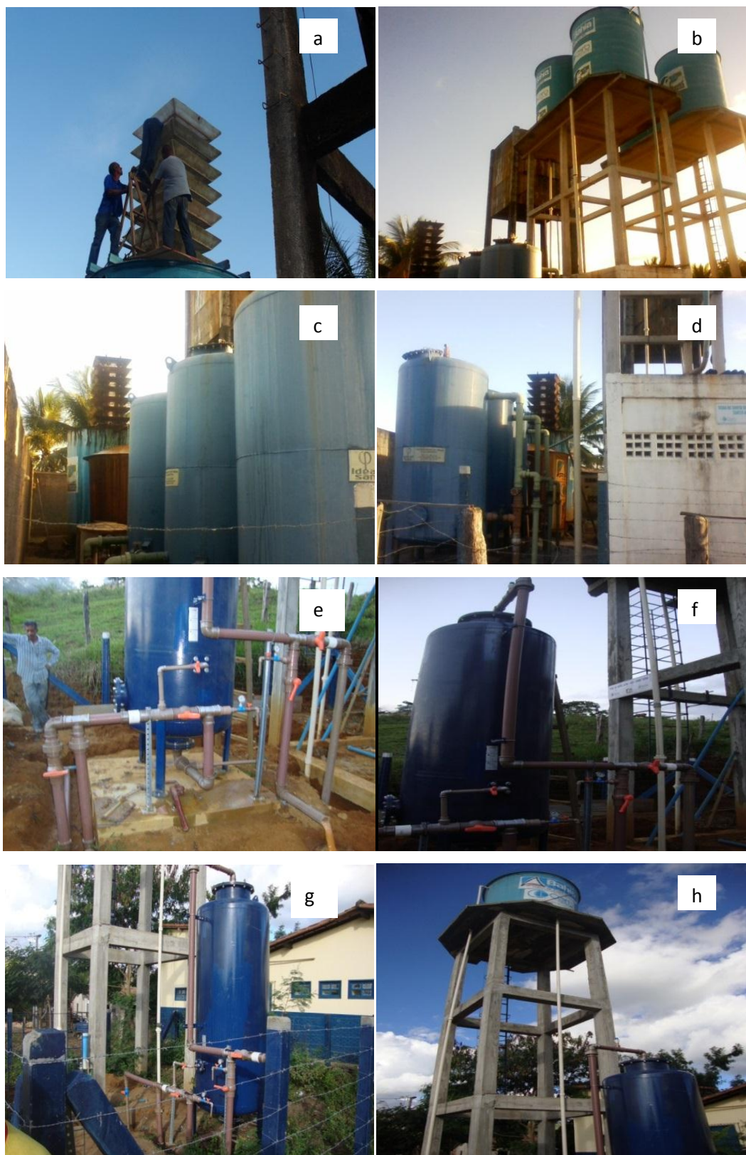
Figura 15. Sistemas de abastecimento de água instalados com equipamentos para remoção de ferro da água em: Santo Antônio (a –b); Assentamento Coari Terra (c – d) e Chapadinha (e – f). Fonte: O Autor.
