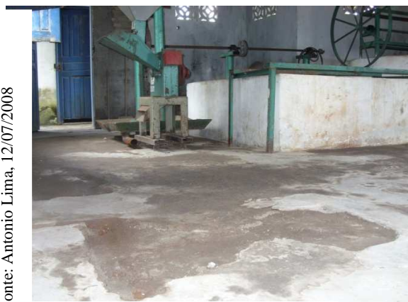
Fig. 27 Piso sofrendo infiltração
