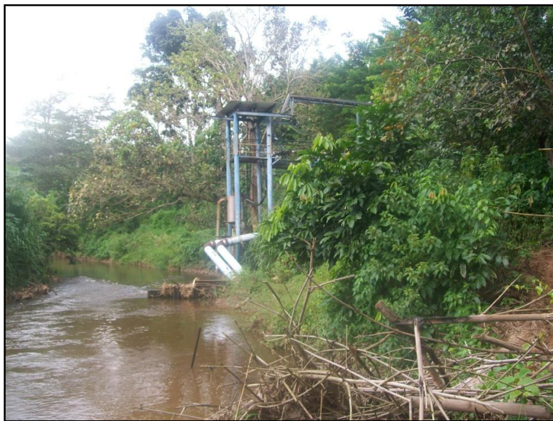
Figura 17: Captação de água à montante do ponto RCN-SUB-300
