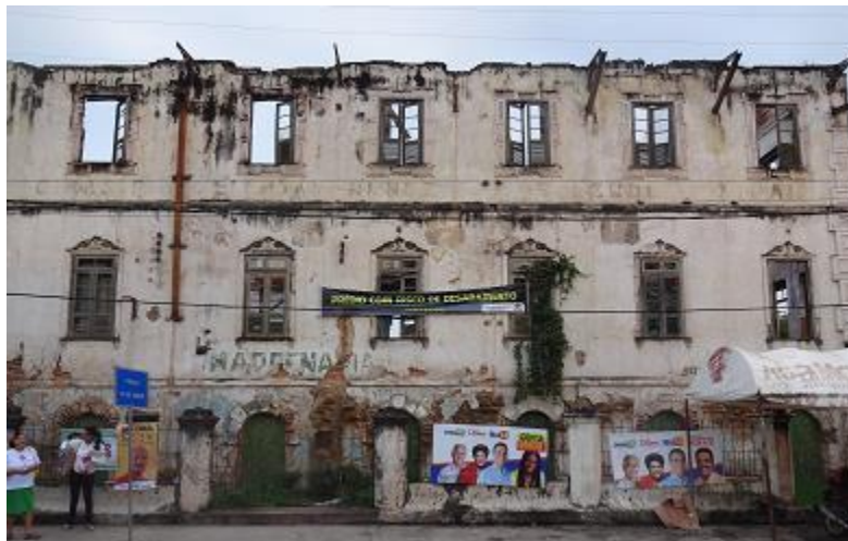
Figura 73, abaixo. O Irapuru, atualmente. Na faixa (posta pela prefeitura), preta com letras amarelas, na parede do prédio, está escrito “Prédio com risco de desabamento”. Acervo de Shanti Marengo. 23/09/2014.
