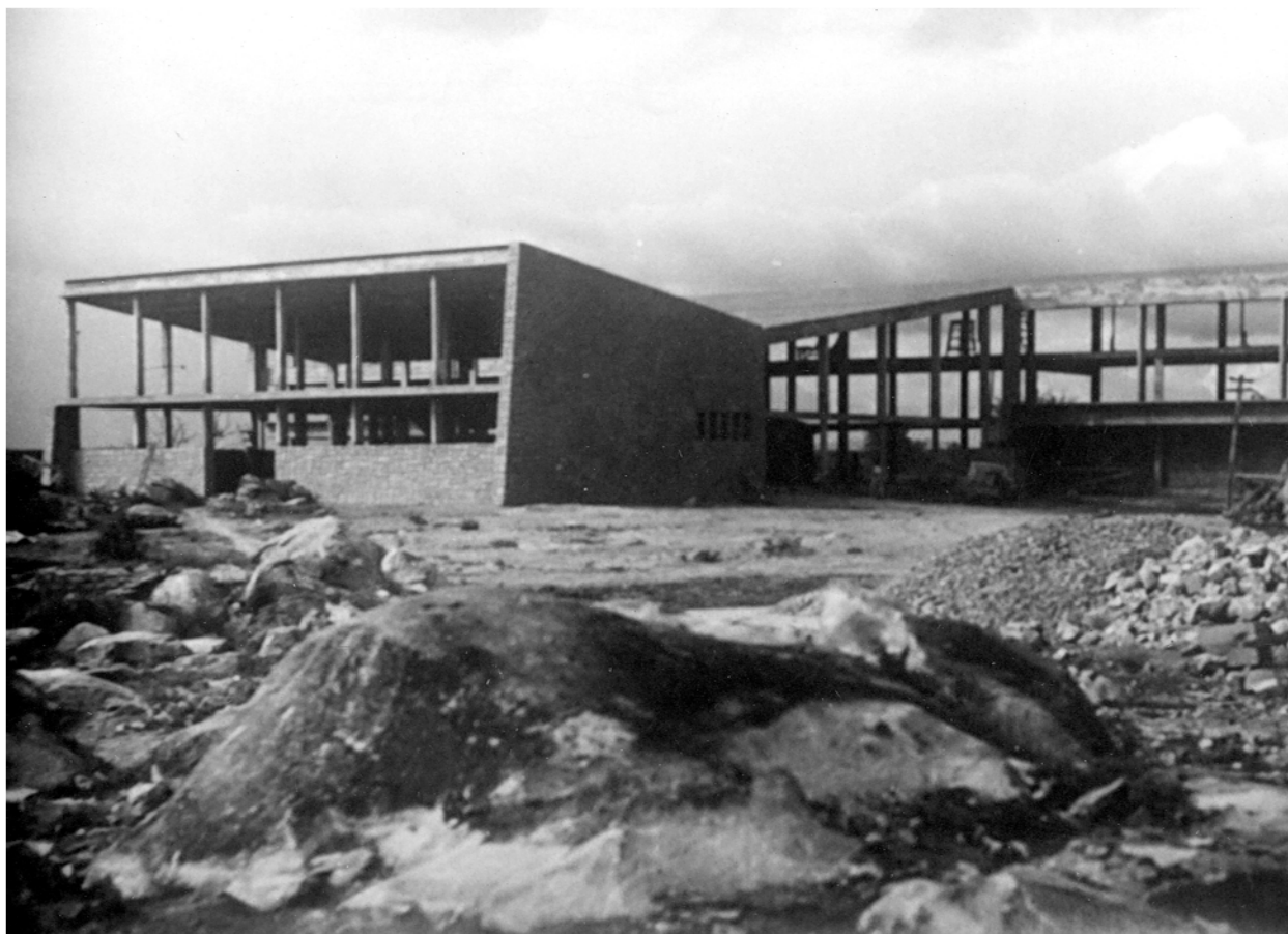
Figura 5.60 – Hotel Paulo Afonso em construção: em primeiro plano, setor de serviços (Fonte: Arquivo da Superintendência do IPHAN/BA, Salvador)
