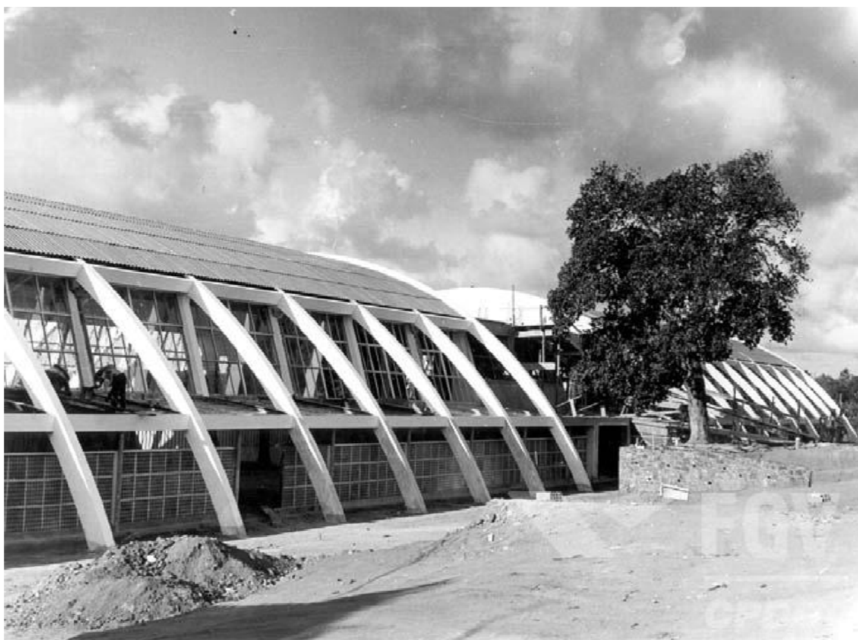
Figura 3.64 – Pavilhão de Atividades de Trabalho: etapa final de construção (Fonte: Arquivo Anísio Teixeira, CPDOC/FGV – ATFOTO 026_6)
