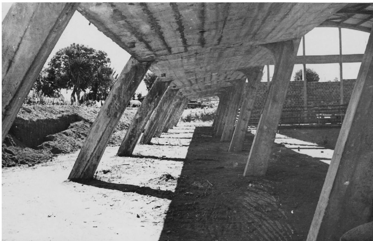
Figura 3.63 – Pavilhão de Atividades de Trabalho: estrutura recém-levantada, sem as vedações e esquadrias (Fonte: Arquivo Diógenes Rebouças – CEAB/FAUFBA)
