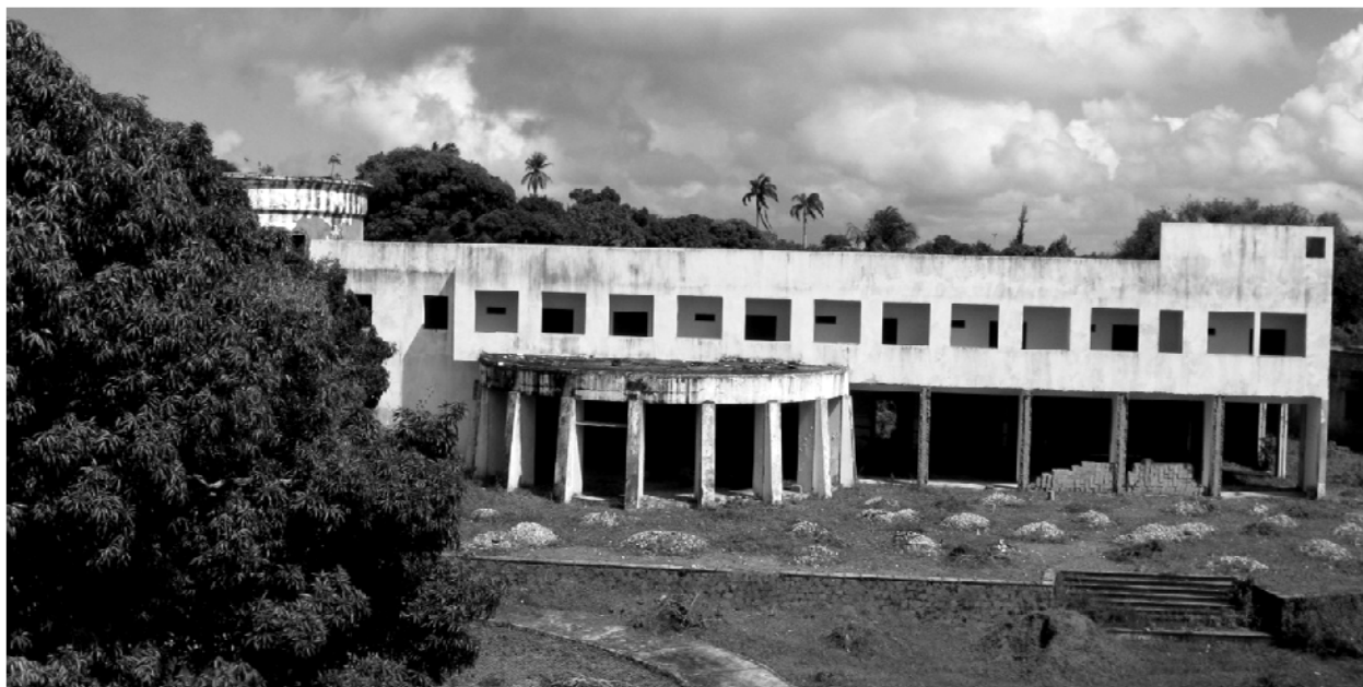
Figura 5.08 – Estado atual da ala norte do Grande Hotel de Itaparica (Foto realizada pelo autor, 23 jul 2010)
