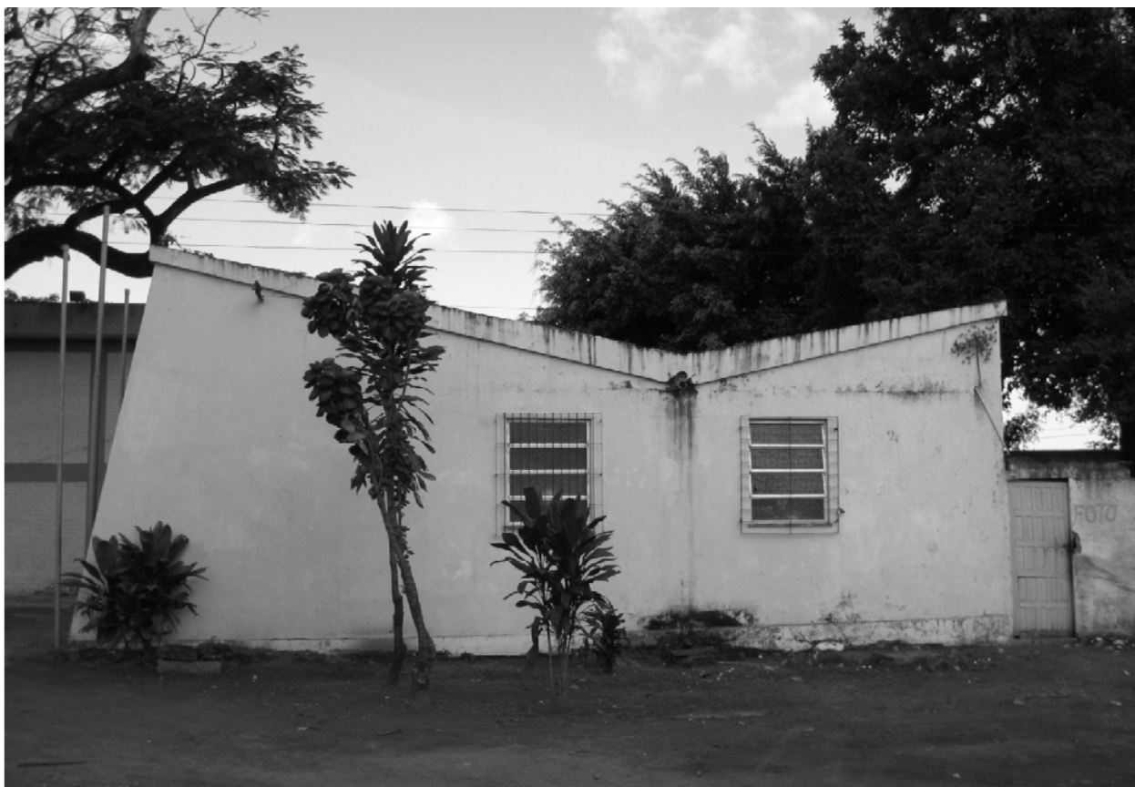
Figura 3.43 – Fachada lateral da residência do diretor, localizada aos fundos da Escola-Classe II (Foto realizada pelo autor, 12 ago 2010)
