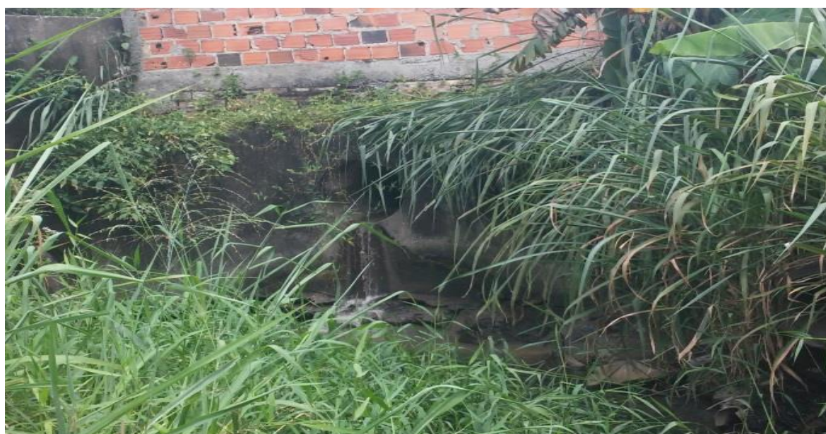
Figura 14 - Lançamento de esgoto no rio Ipitanga em Simões Filho – BA
