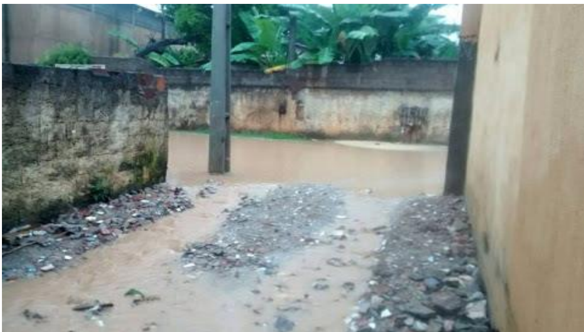
Figura 20 - Alagamento devido às chuvas no bairro Cassange
