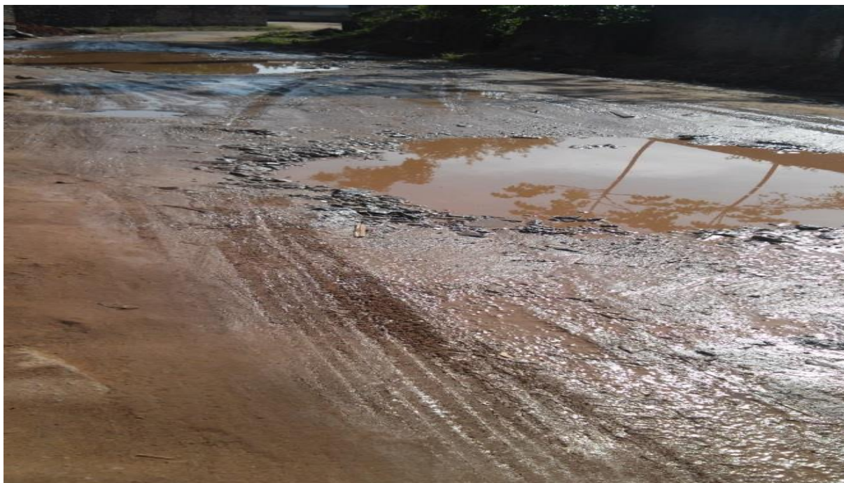
Figura 11 - Falta de asfaltamento no bairro Cassange
