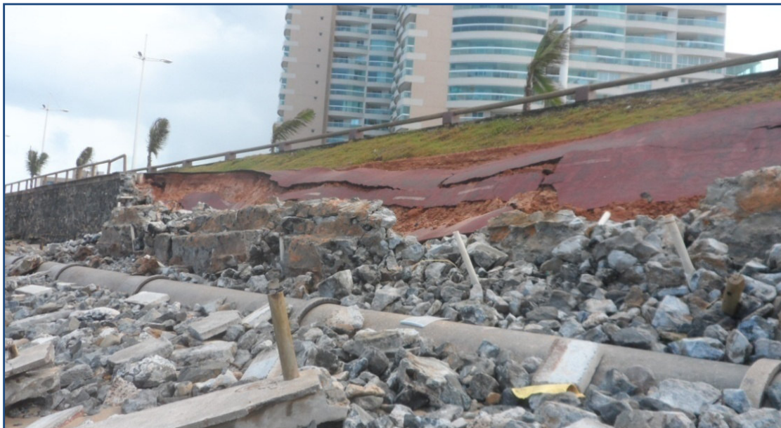
Figura 33: Ciclovia destruída pela erosão costeira em trecho de praia da Pituba (II) - Salvador/Bahia, 2015.
