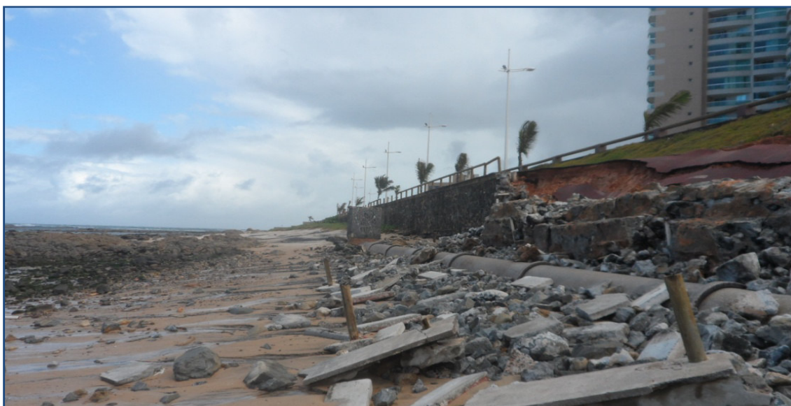
Figura 32: Ciclovia destruída pela erosão costeira em trecho de praia da Pituba (I) - Salvador/Bahia, 2015.
