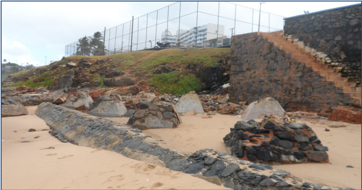
Figura 25: Estrutura rígida destruída por erosão costeira em trecho da praia de Santana, Rio Vermelho - Salvador/Bahia, 2015.
