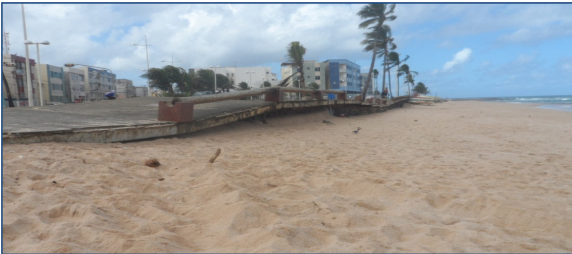
Figura 27: Calçada destruída pela erosão costeira em trecho de praia da Amaralina - Salvador/Bahia, 2015.
