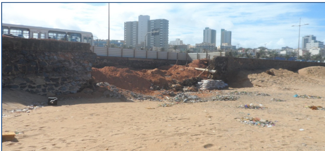
Figura 34: Muro de alvenaria de pedra destruído pela erosão costeira na praia do Chega Nego (Jardim dos Namorados), Pituba, foz do rio Camurujipe - Salvador/Bahia, 2015.
