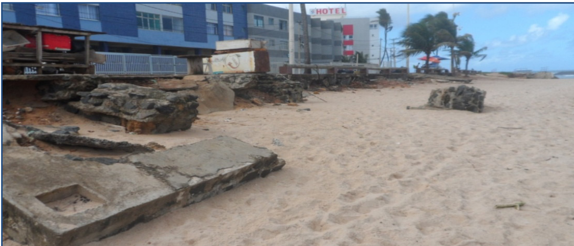
Figura 28: Estruturas rígidas destruídas pela erosão costeira em trecho de praia da Amaralina - Salvador/Bahia, 2015.
