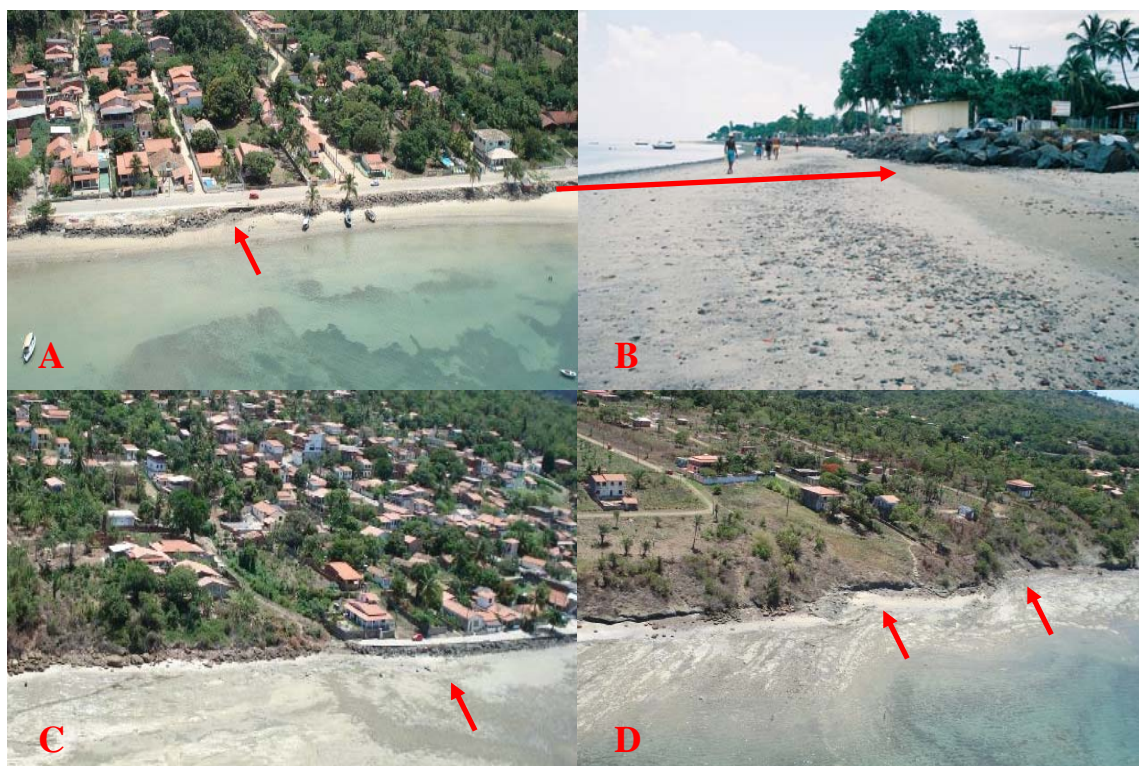
Figura 25: A e B- Obras de contenção em Amoreiras, indicando processo de erosão para escala de curto prazo (anos); C e D- Obras de contenção e falésias ativas no trecho entre Manguinhos e Bom Despacho indicando processo de erosão para escala de longo prazo (séculos).
