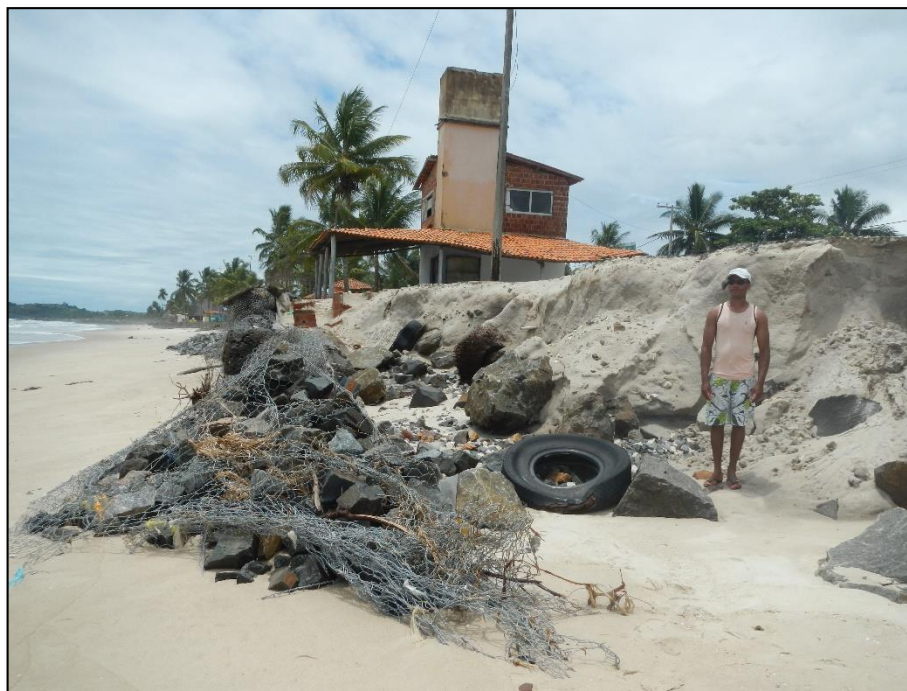
Foto 3 – Colapso de estrutura de contenção, Praia de São Domingos – trechos 2.
