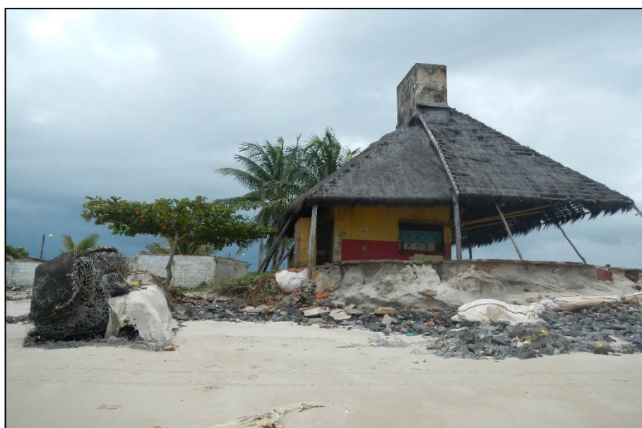
Foto 2 – Destruição de infraestrutura recreacional, Praia de São Miguel.
