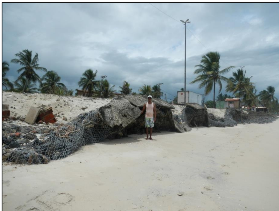
Foto 4 – Calçada de pedestres e muro de arrimo destruídos pela erosão e rodovia ameaçada (Praia de São Domingos – trecho 2).
