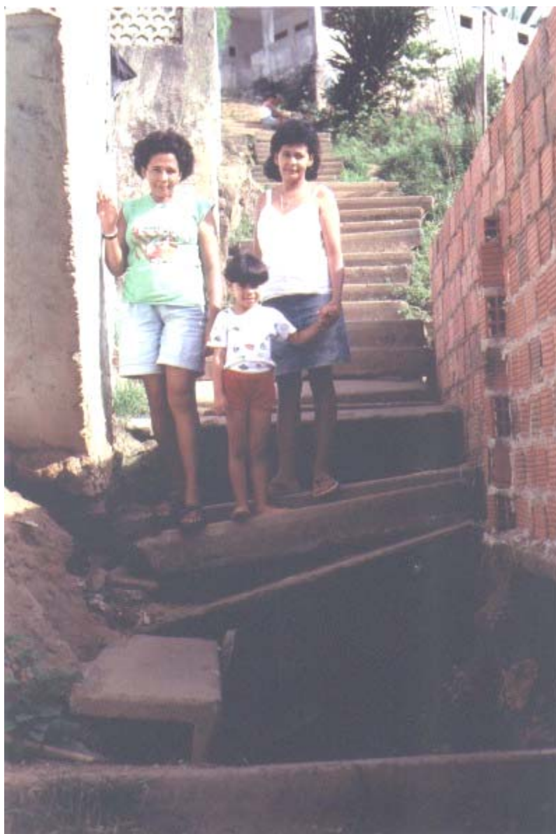
Foto 11 – Escadaria e Rampa Drenante danificada em Bom Juá
