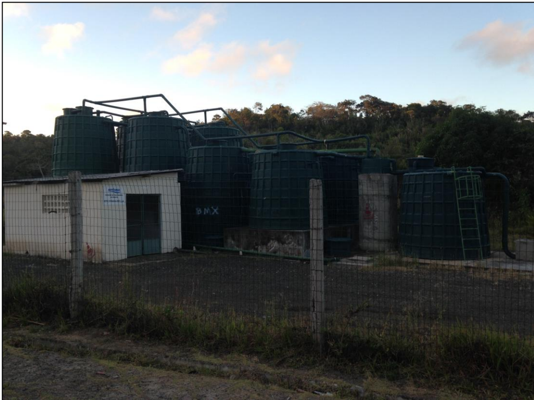
Figura 9 – Estação de tratamento de esgoto do programa “Minha Casa, Minha Vida”, na comunidade Mar Bello, em Imbassaí - 2015
