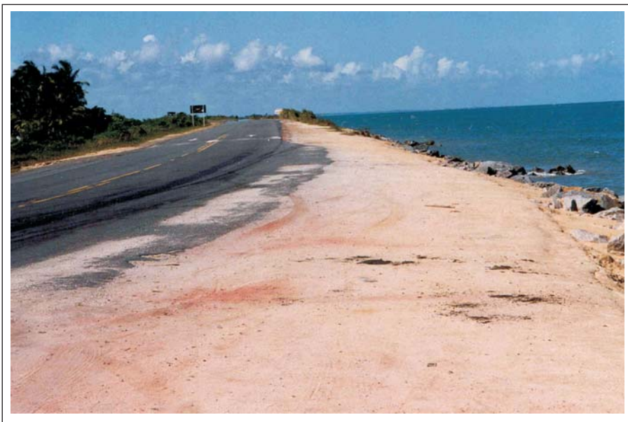
Foto 18 - Estrada ameaçada pela erosão em Ponta Grande ( Fig. 13).
