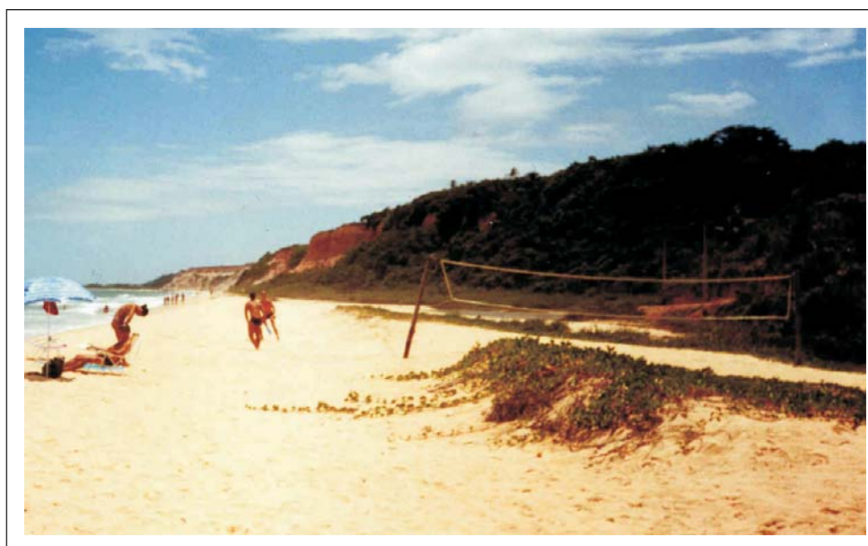
Foto 36 - Falésia com mínimo risco de desabamento (Risco B) entre Arraial D'Ajuda e Trancoso (Fig. 15).
