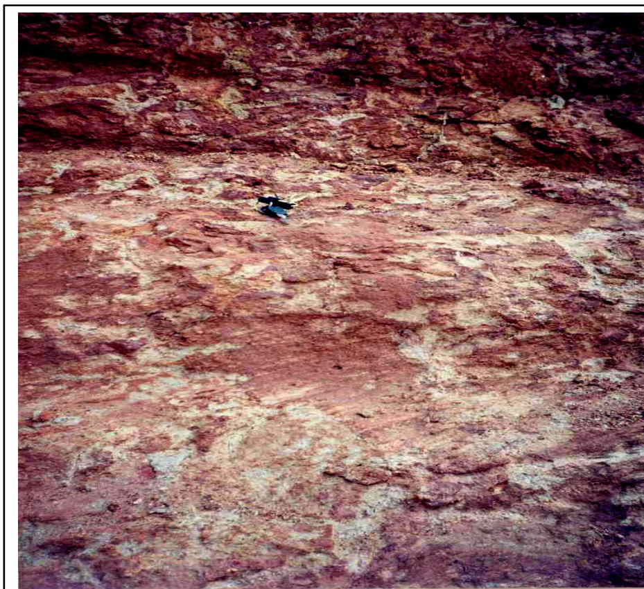
Foto 5.5. Ocorrência de colúvios num corte da CE-421, estrada no sentido Pecem-Taíba. Observam-se na parte superior e inferior do corte, aspectos da caulinação dos feldspatos da rocha proveniente da intemperismo químico, com decomposição dos minerais mais básicos. Numa visão mais geral, um leve desenho da textura original da rocha com bandeamentos gnáissicos migmatizados.
