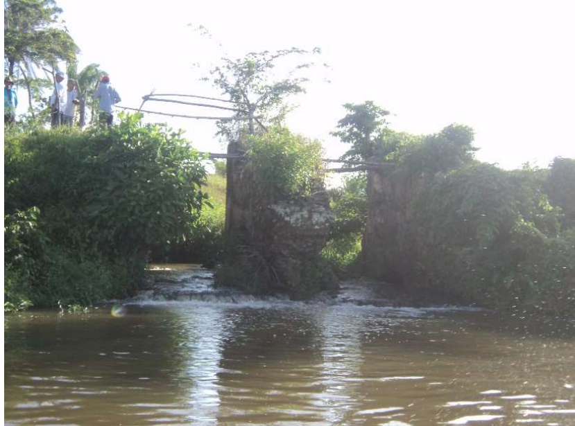
Figura 6 Ruína da Represa da Cruz no Rio Acu
