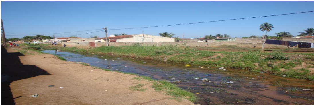
Imagem 8: Passagem de água mal resolvida no Bairro de Fomento. Fonte: Elaboração própria.
