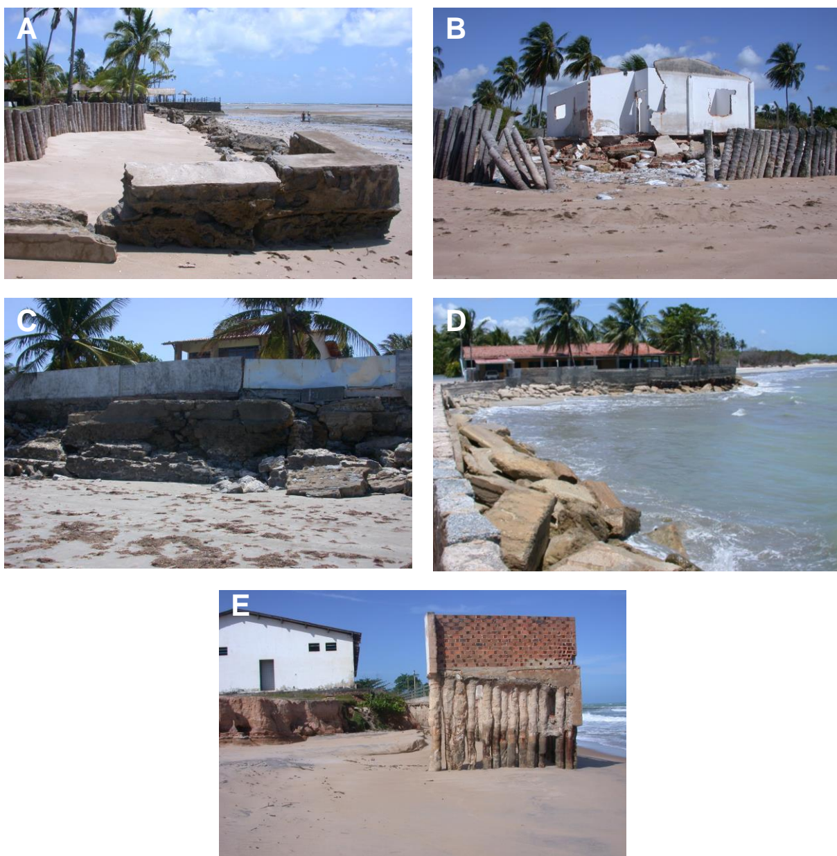
Figura 104 – Exemplos de destruição de estruturas de proteção ao longo da linha de costa do Estado de Alagoas: A – Muros de arrimo na praia de Peroba; B – Estrutura de proteção feita com toras de coqueiros na praia da barra do Tatuamunha; C – Muro de proteção na praia da Barra de Santo Antônio; D – Estrutura de proteção na praia do Pratygy; (ver figura 101 para localização).
