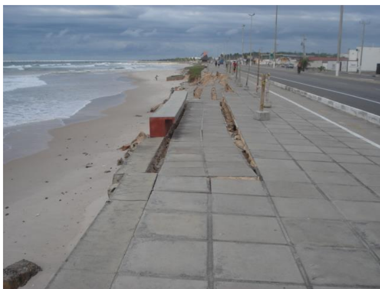
Figura 60 - Destruição da calçada da avenida Assis Chateaubriand, na praia do Sobral, causada pela ressaca marítima do dia 18/09/2007 (jornal “Alagoas em Tempo Real”, edição do dia 18/08/2007).
