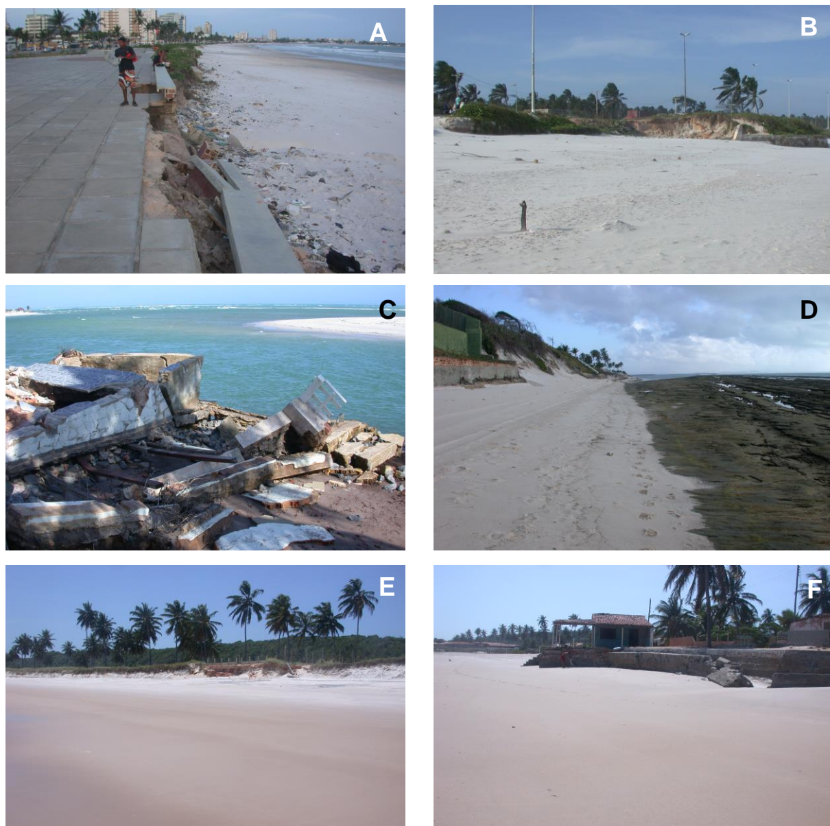
Figura 87 – Morfologias costeiras e obras de proteção observadas em locais onde há focos convergência de onda de uma ou mais direções (E, SE e S): A – Trecho costeiro na praia do Sobral mostrando destruição parcial do muro de arrimo que protege o calçadão B – Destruição de parte da estrutura de proteção da linha de costa na praia do Pontal da Barra; C – Casa destruída na localidade de Barra Nova; D – Escarpa erosiva no terraço arenoso e destruição de muros de arrimo na praia do Saco da Pedra; E – Escarpa erosiva no terraço arenoso na praia da gameleira; F – Muro destruído na praia da Lagoa do Pau (ver figuras 69, 70 e 71 para localização).
