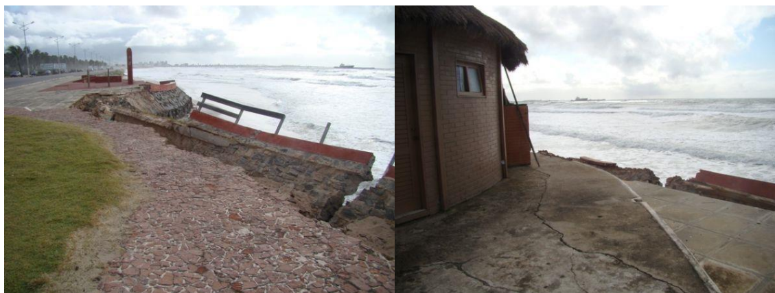
Figura 73 - Ressaca marítima causa destruição do calçadão e de parte de uma barraca na praia do Sobral, em Maceió (jornal “Correio do Povo de Alagoas”, edição de 13/09/2010).
