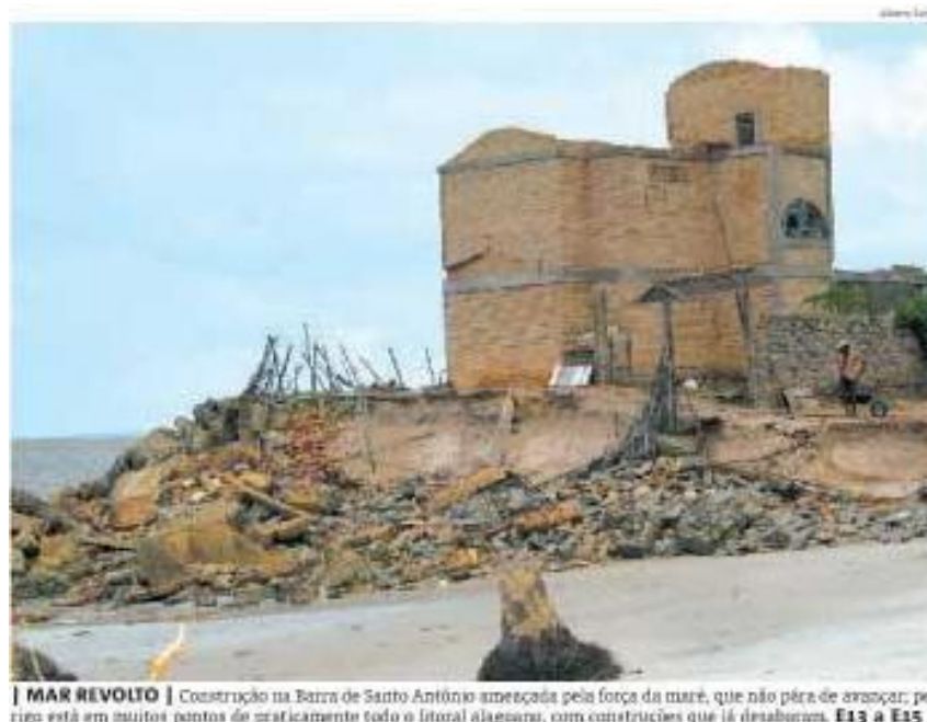
Figura 55 - Construção destruída em Barra de Santo Antônio (jornal “Gazeta de Alagoas”, edição de 28/08/2005).
