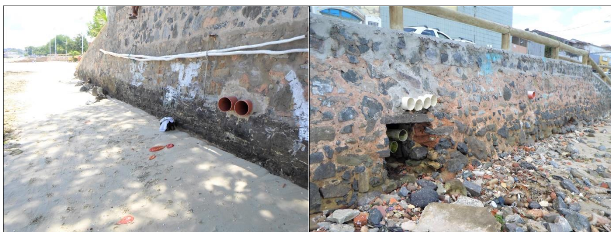
Figura 17 – Galerias de drenagem de águas pluviais na orla da Ribeira
