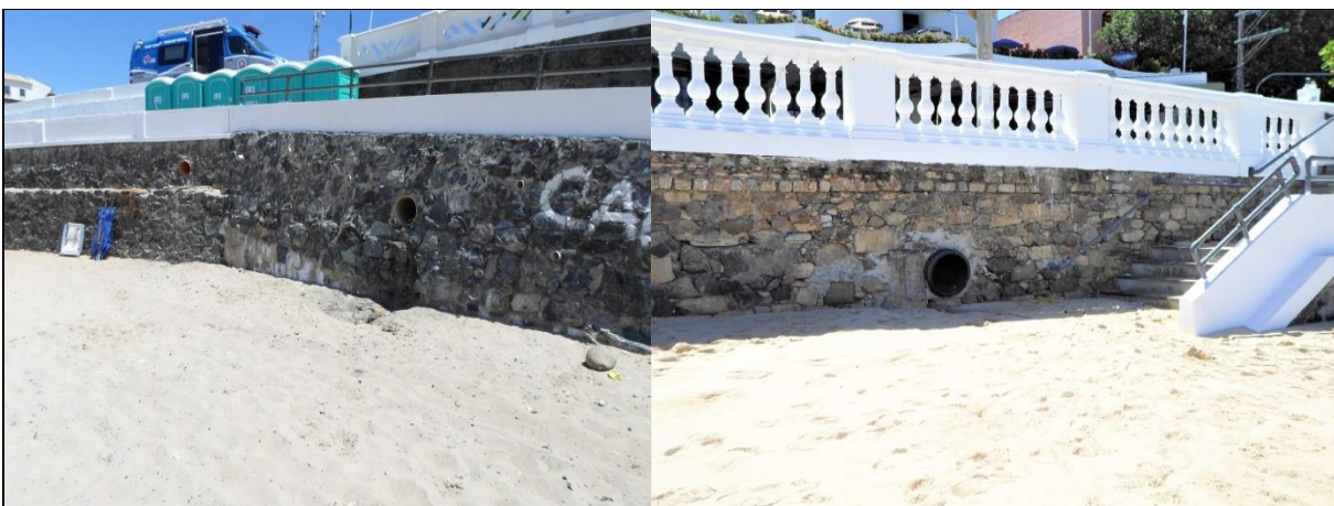
Figura 23 – Galerias de drenagem de águas pluviais na orla da Barra
