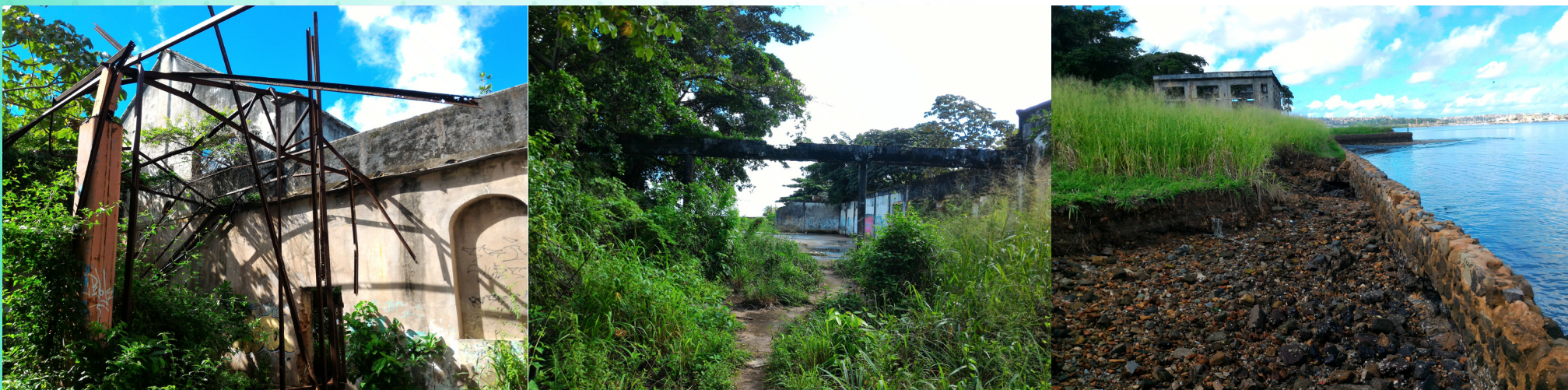
Fotos 13, 14 e 15: Vista da ruína do pavilhão marítimo da Fábrica São Braz. Rafael Rodamilans, 2017
