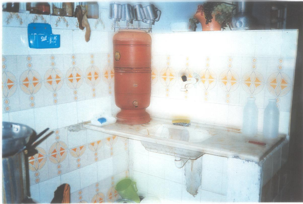
FOTO 13: Residência C - ponto interno de água.
