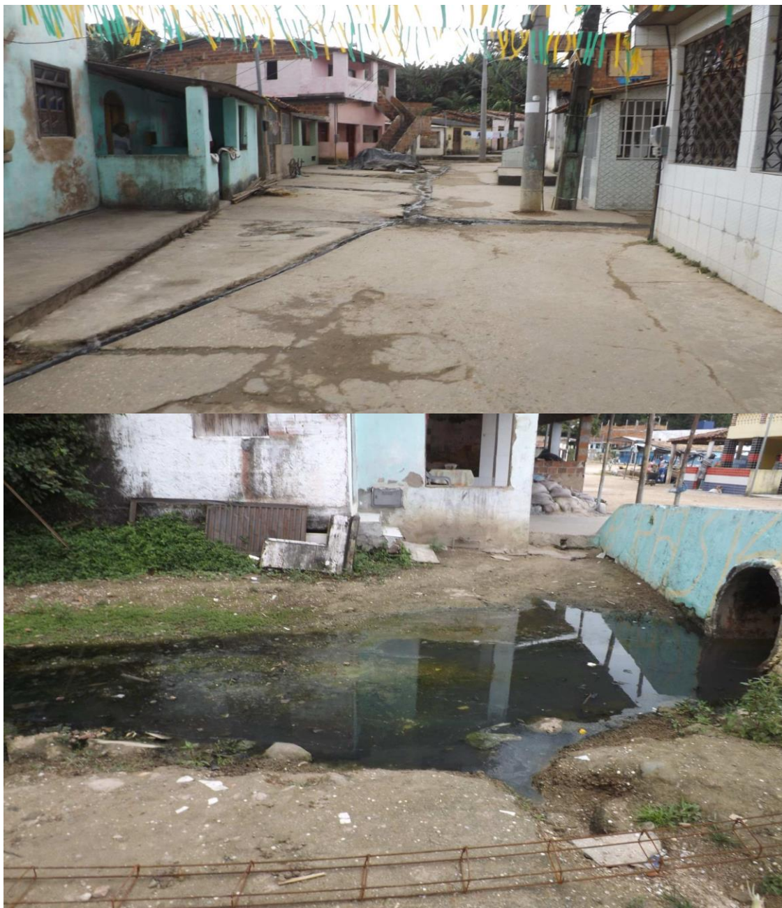
Figura 12 – Esgotos a céu aberto na Rua do Beco, Praia Grande, Ilha de Maré, Salvador-BA. Agosto, 2014.
