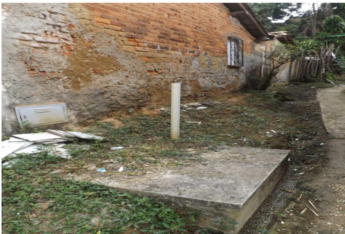
Figura 11 – Fossa séptica situada na Rua do Beco, Praia Grande, Ilha de Maré, Salvador-BA. Agosto, 2014.
