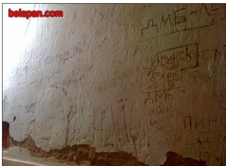
Figura 14 – Paredes do banheiro do Hospital Militar de Baranavičy.
