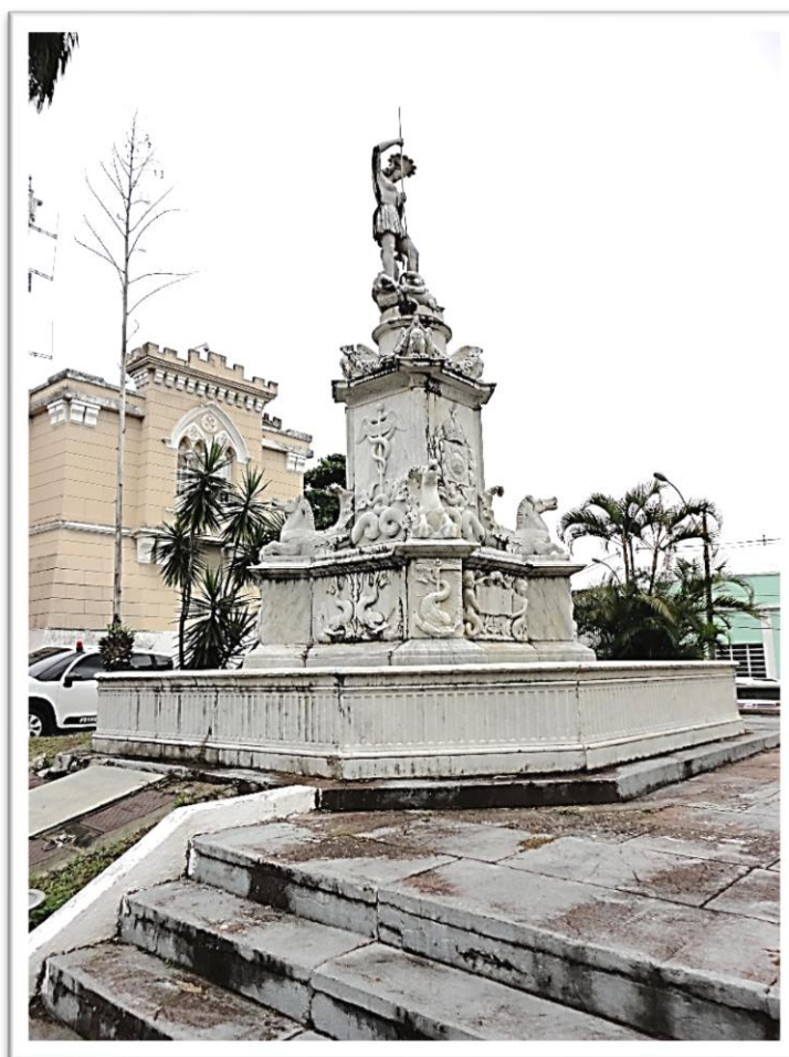
FIGURA 123- Chafariz da Cabocla, atualmente no Largo dos Aflitos. Estruturalmente íntegro, mas há crosta negra e biofilme e fluxo de água interrompido.
