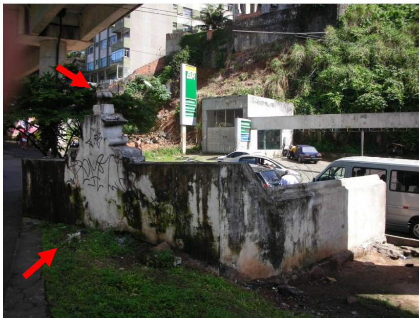
FIGURA 16- Neste ângulo, observamos a parte posterior do monumento, coberto pelo biofilme e marcado por pichações com tinta spray. Podemos ver ainda o descuido com a manutenção da vegetação do canteiro e presença de lixo. Indicamos com a seta no canto superior esquerdo da imagem, o coroaamento do frontispício que foi quebrado e jazia até pouco tempo logo abaixo, indicado pela seta inferior. Na última visita ao local (julho de 2011) esta parte havia desaparecido tendo sido possivelmente roubada.
