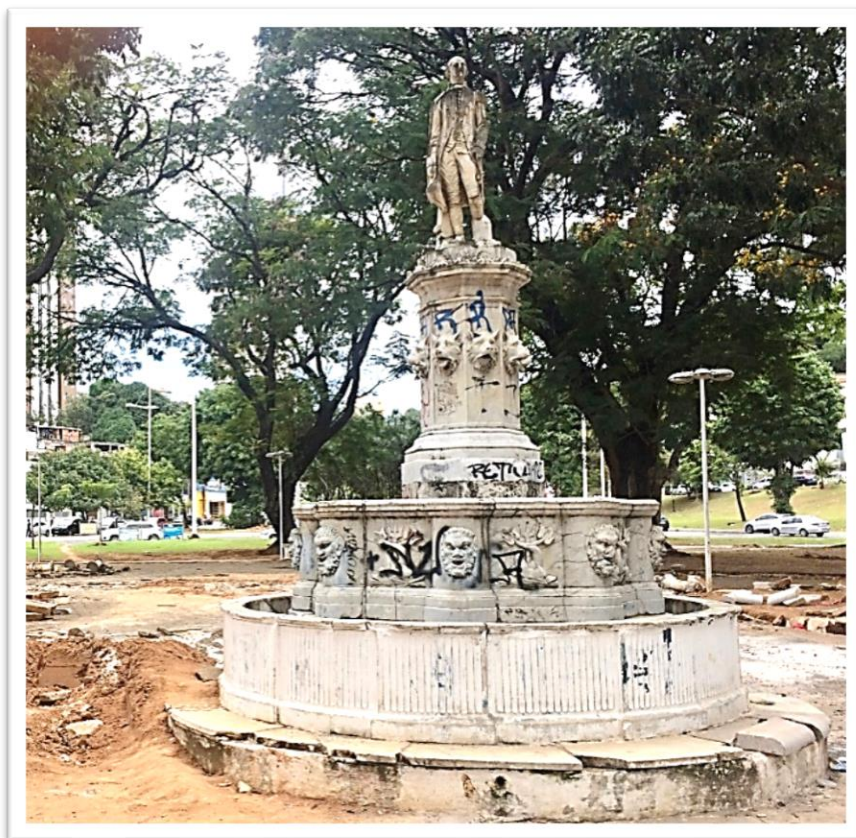
FIGURAS 133 a 135- Chafariz de Lorde Cochrane, problemas estruturais e estéticos.
