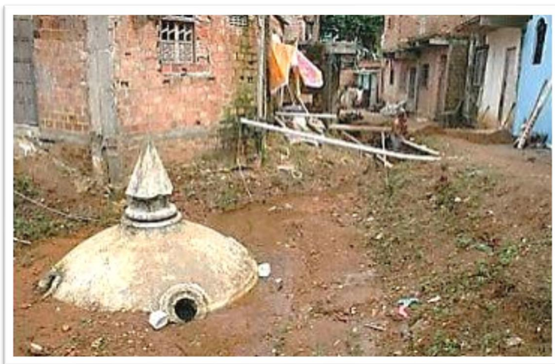
FIGURA 116- Fonte do Vale do Tororó, soterrada em área de ocupação urbana irregular. Seus óculos serviam de acesso para a água.
