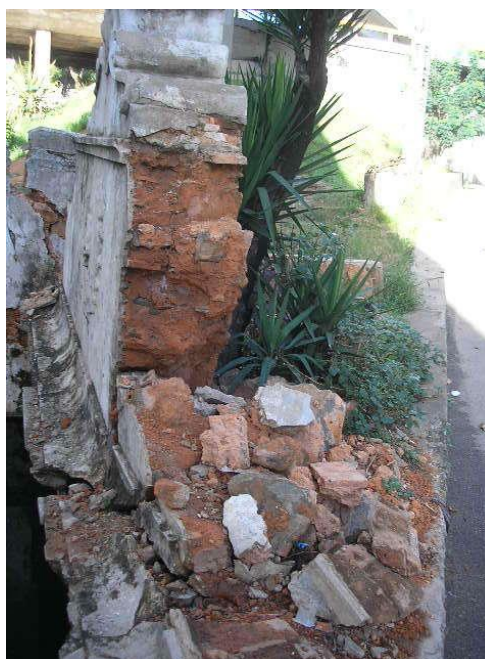
FIGURA 13- Outro detalhe mostra a destruição da alvenaria da Fonte das Pedras em 2007. (Imagem cedida pela Fundação Gregório de Matos)
