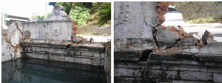
FIGURA 11 e 12- A Fonte das Pedras em 2007, após a colisão de um ônibus e destruição parcial de sua alvenaria. Por sorte, os relevos decorativos principais não foram atingidos no sinistro. (Imagens cedidas pela Fundação Gregório de Matos)
