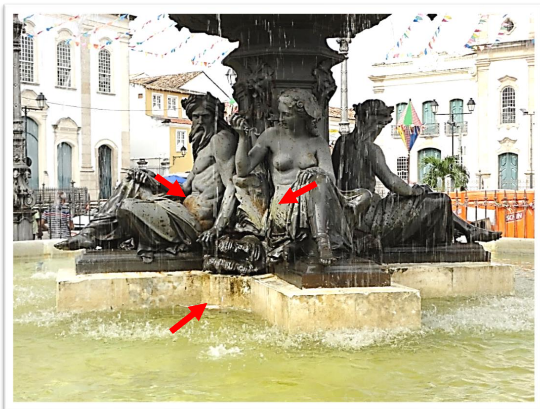
FIGURAS 120 a 122- Chafariz do Terreiro de Jesus, na atualidade. Formação de crosta negra, biofilme e oxidação de partes constituintes.
