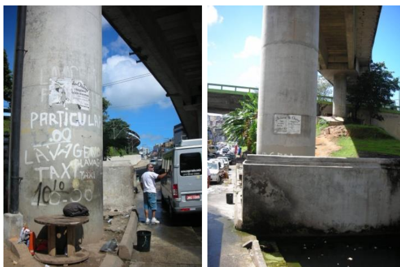
FIGURAS 7 e 8- Pilar do elevado do futuro metrô de Salvador, muito próximo à Fonte das Pedras é utilizado pelos lavadores de veículos como local para sinalização. No local, a desordem causada pelo acúmulo de lixo e de materiais diversos compromete a leitura do monumento.
