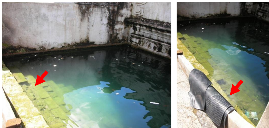
FIGURA 18 e 19- A água represada na Fonte das Pedras encontra-se poluída pelo uso dos lavadores de veículos. A falta de controle de acesso tem como consequência ainda danos à escada, que apresenta já perdas de partes constituintes. O uso da Fonte das Pedras como local para lavagem de veículos é certamente um dos mais agressivos agentes deteriorantes. Além de poluir a água, o descuido geral é motivo de comprometimento estético de um dos mais belos exemplares da nossa Arquitetura da Água.
