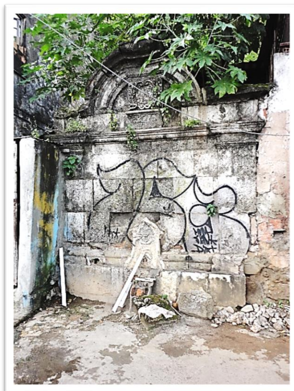
FIGURAS 101 e 102- Fonte da Munganga na atualidade. Danos estruturais e vandalismo.
