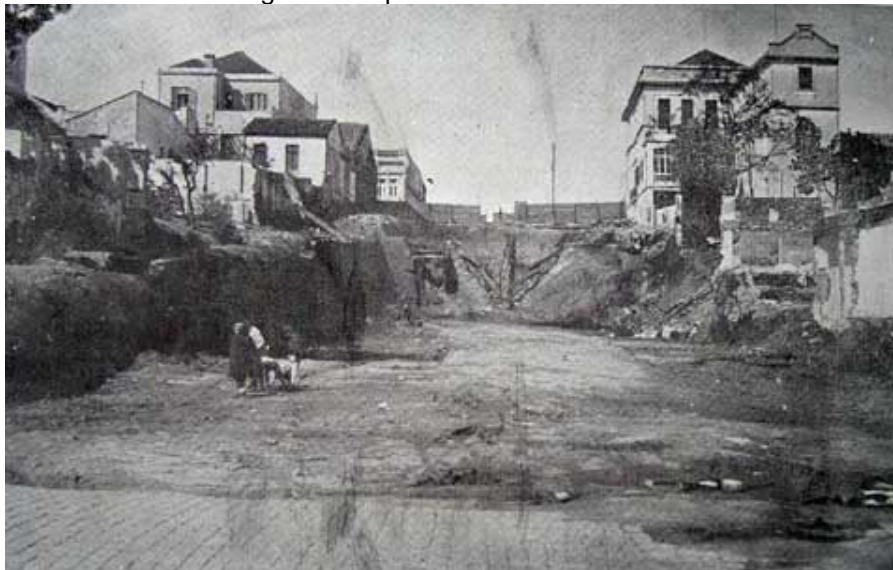
Figura 5 Início da construção da Avenida Borges de Medeiros e o corte no perfil natural do terreno, registro de aproximadamente 1928.
