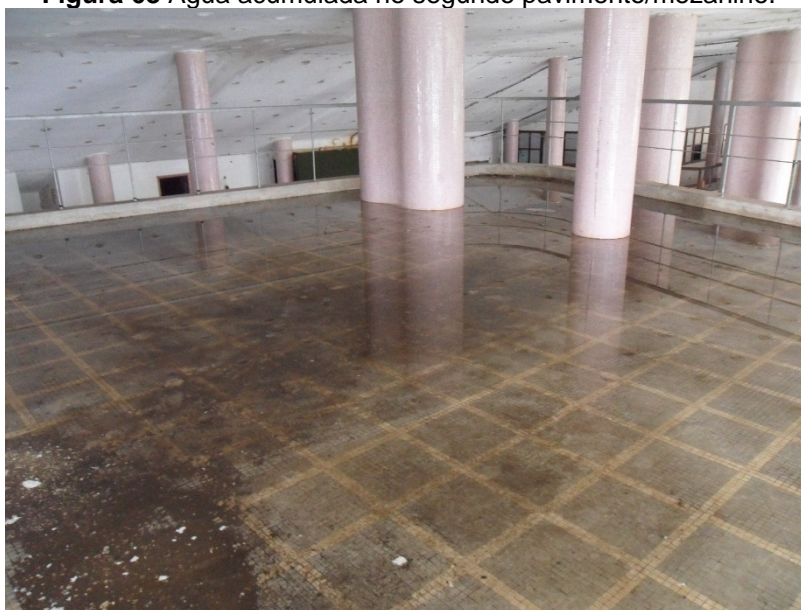
Figura 68 Água acumulada no segundo pavimento/mezanino.
