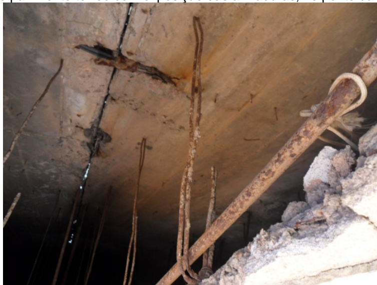
Figura 72 Laje do pavimento térreo com exposição das armaduras, no ponto da junta de dilatação.
