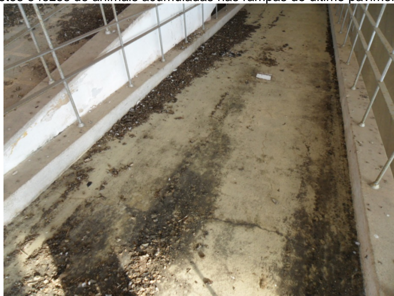
Figura 69 Dejetos e fezes de animais acumuladas nas rampas do último pavimento do Pavilhão.
