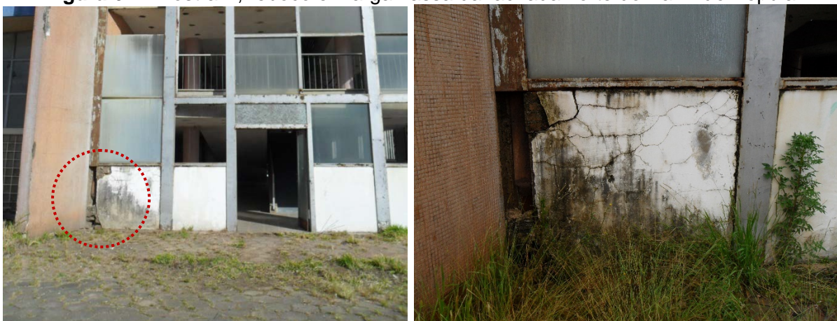
Figura 62 Amostra A, reboco em argamassa da fachada norte do Pavilhão Popular.
