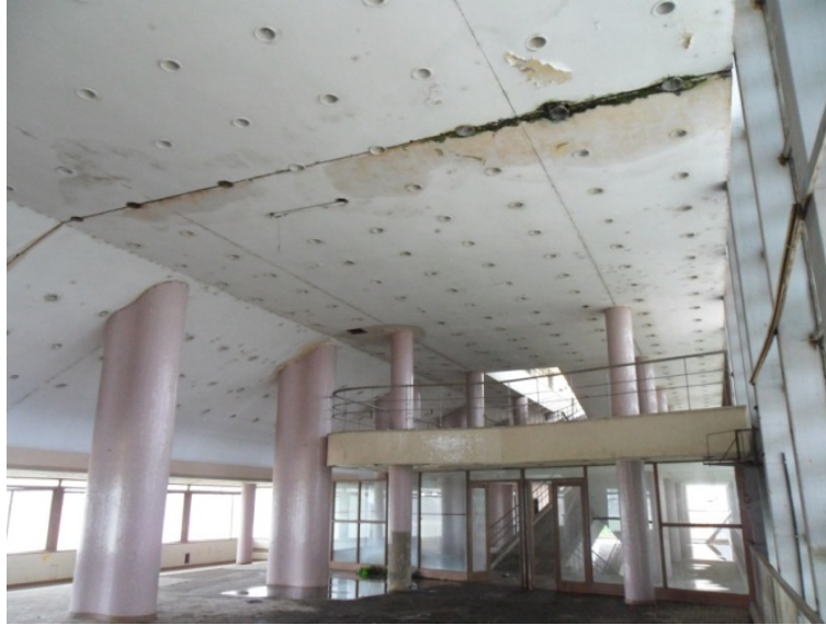
Figura 66 Forro do terceiro pavimento, logo abaixo da laje do último pavimento. Observa-se a junta de construção apresentando bastante manchas de água e presença de micro-organismos.
