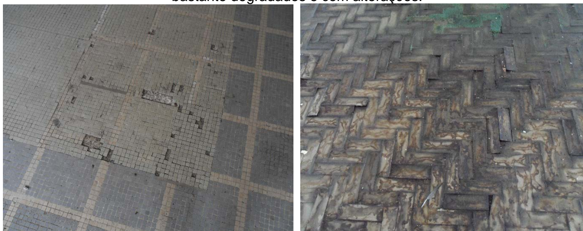
Figura 28 Piso em ladrilho hidráulico e parquet, presente em todos os pavilhões, nesse caso bastante degradados e com alterações.
