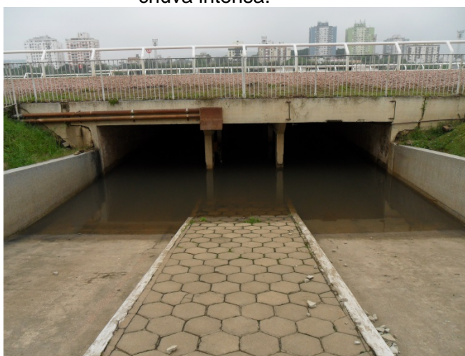
Figura 73 Túnel de acesso ao centro da pista de corridas, inundado após dias de chuva intensa.
