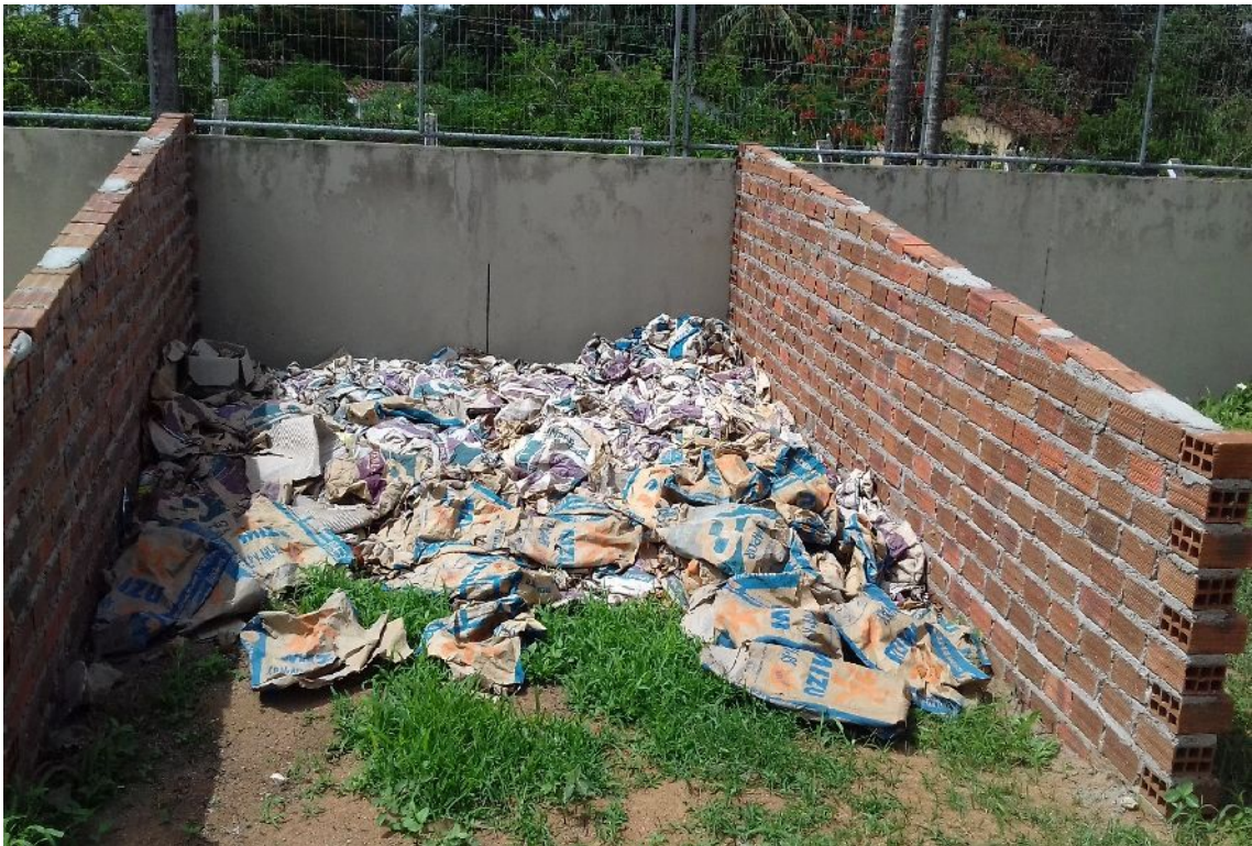
Figura 1.1 - Embalagens de cimento Portland descartadas em canteiro de obra
