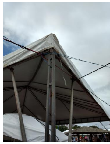
Detalhe da instalação elétrica em uma barraca
