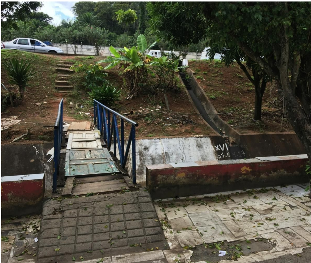
Figura 32 – Manutenção improvisada da ponte sobre o rio Pernambuco, 2017
