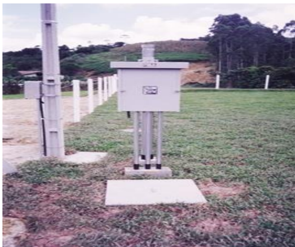
Figura 9: Retificador de corrente elétrica
