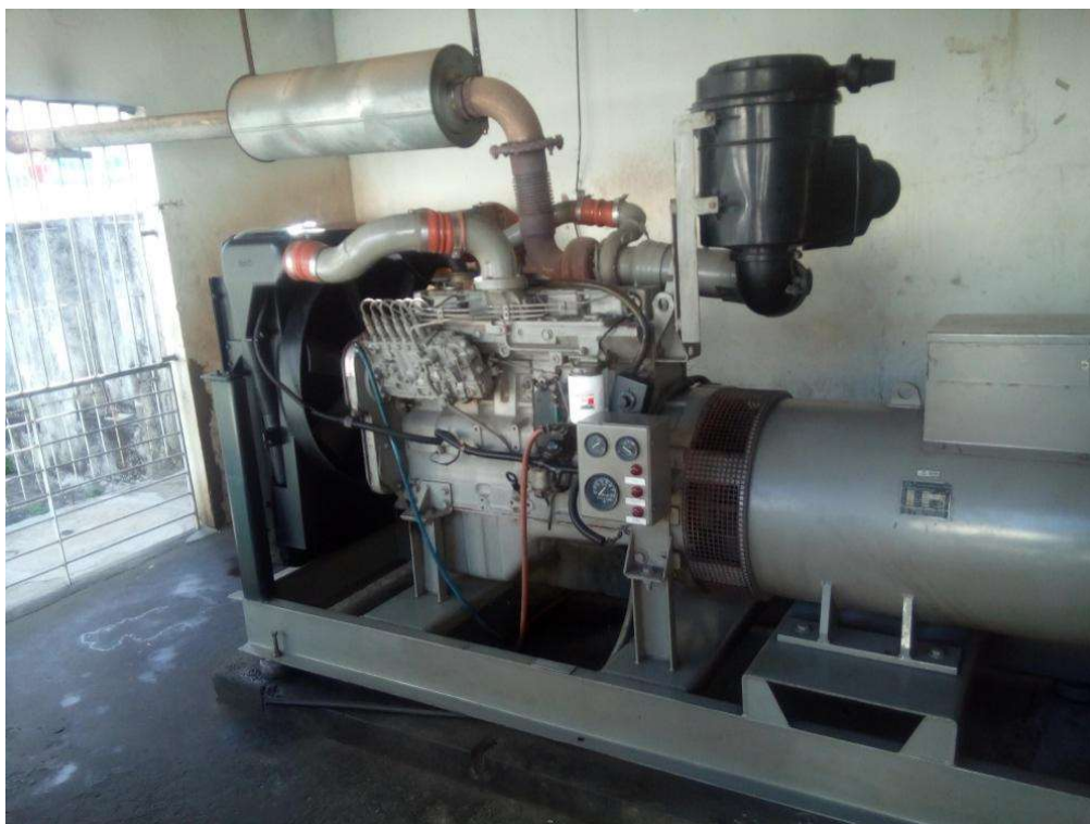
Figura 22: Gerador Diesel e sistema de exaustão.
