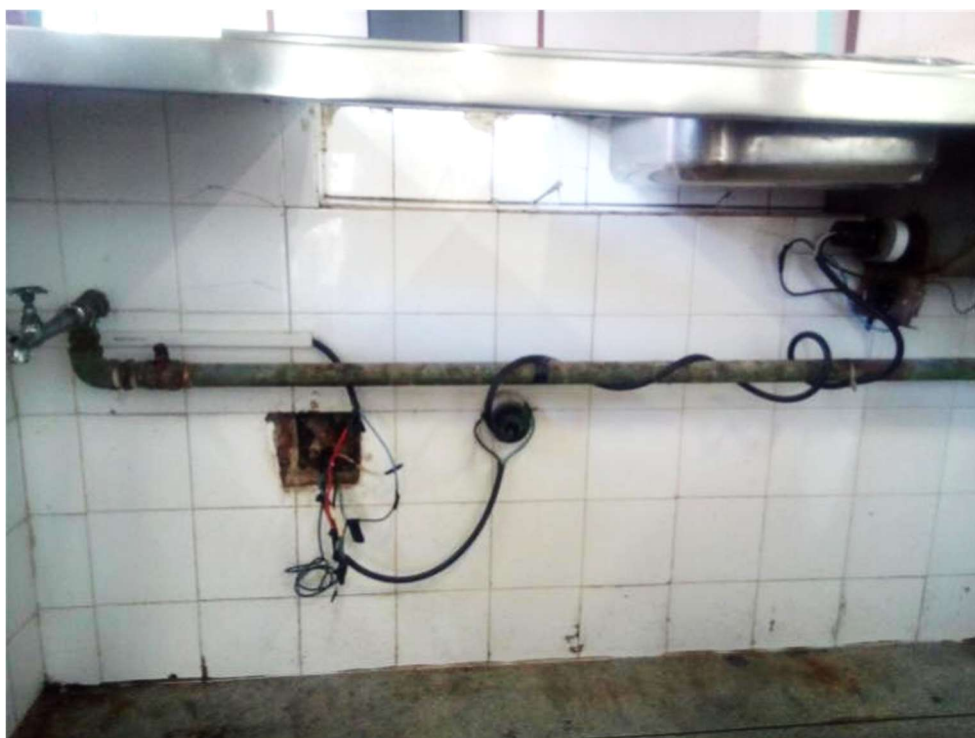
Figura 20. Instalação elétrica da mesa térmica do Buffet do refeitório.
