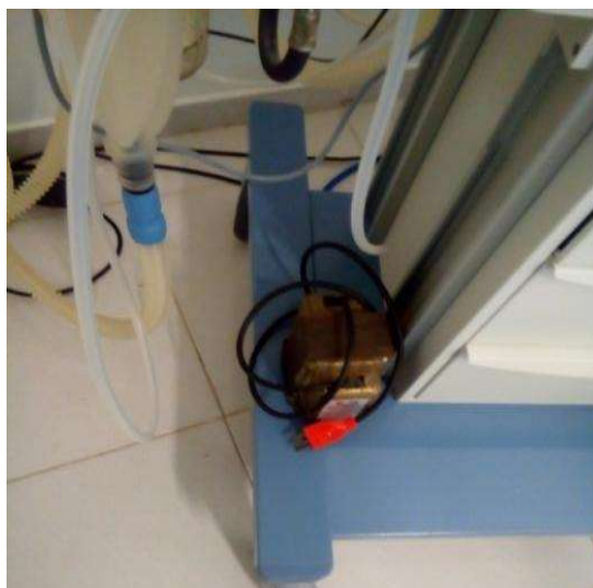
Figura 21: Disposição do Transformador utilizado para a alimentação de equipamentos eletromédicos dentro do centro cirúrgico.
