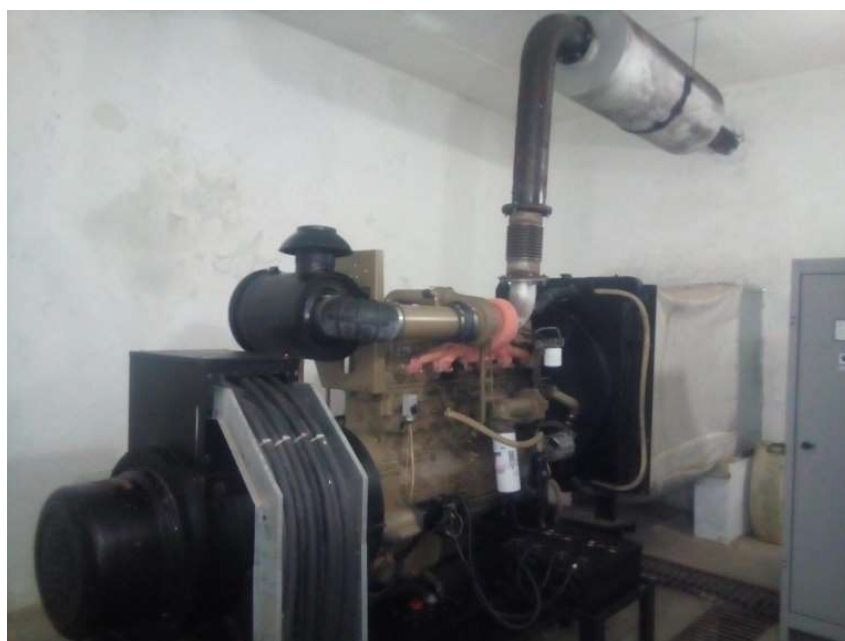
Figura 19: Gerador Diesel e sistema de exaustão.
