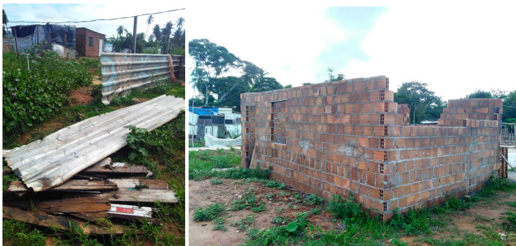
Figura 37: Lotes “Abandonados” e/ou necessitando de manutenção.
