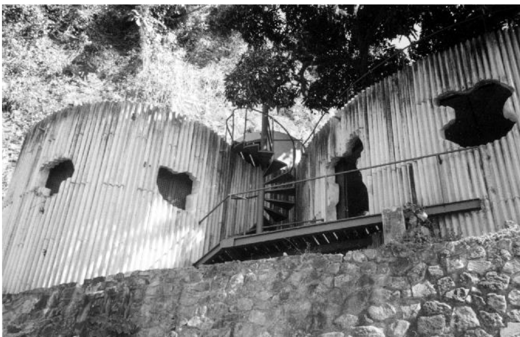
Fig. 25 – Escada externa acrescida à concepção original
