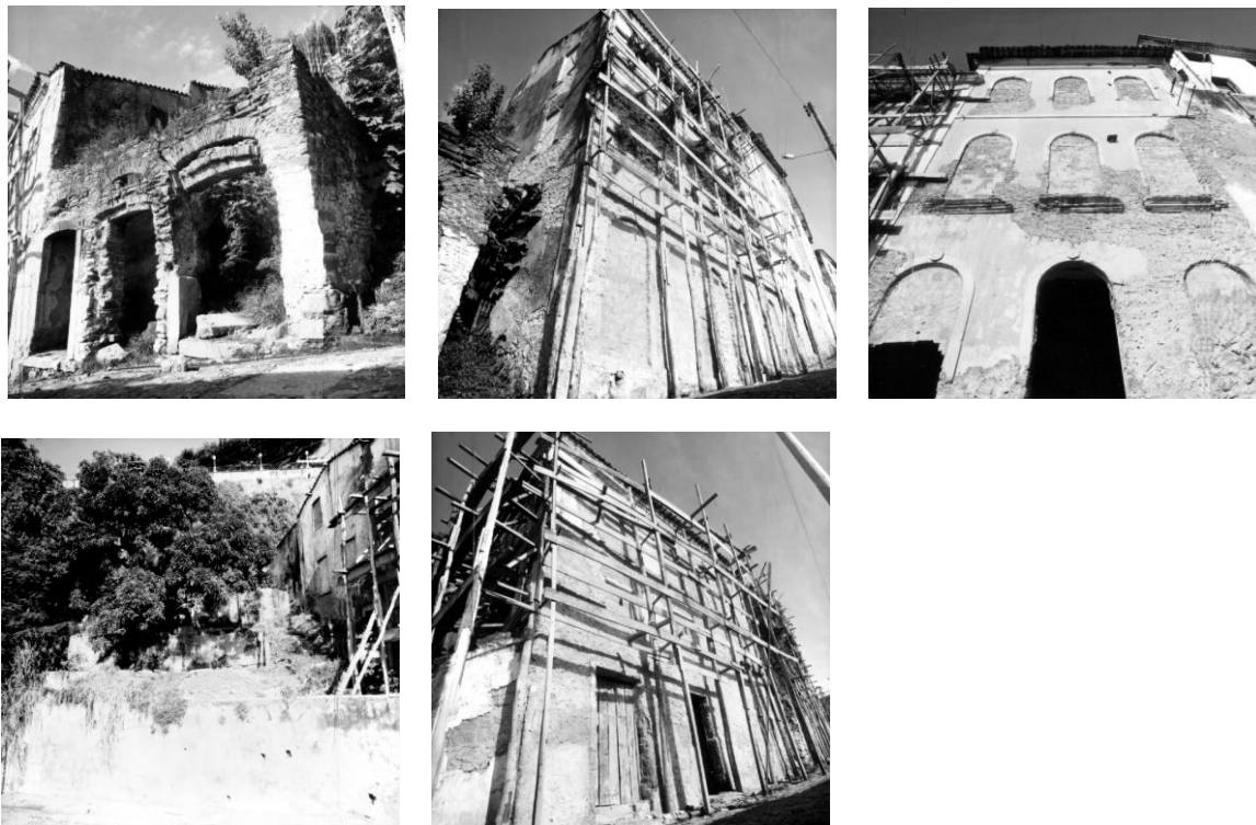
Fig. 11 - Aspecto do estado de degradação em que se encontrava o conjunto em 1986: os sobrados deteriorados, a ruína e o terreno baldio.
