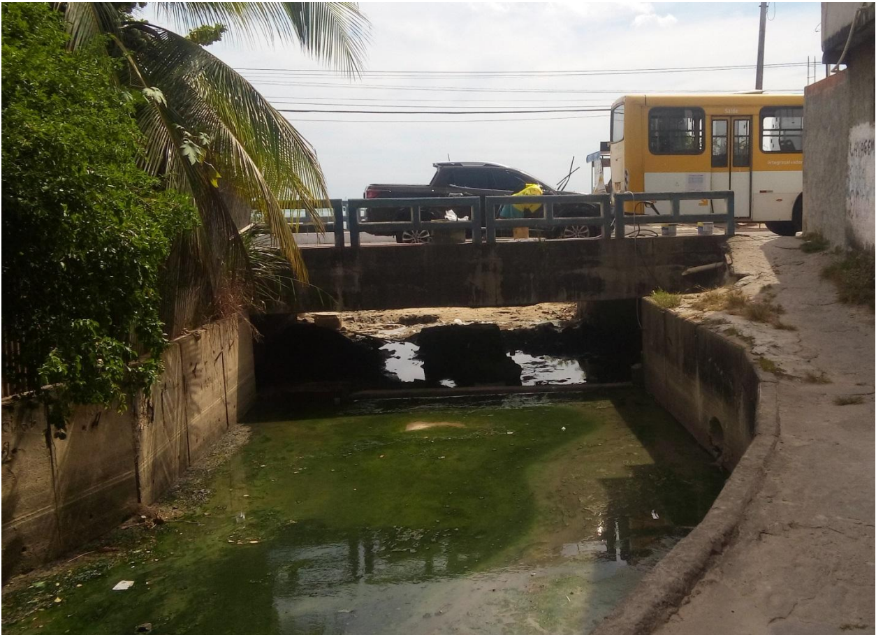
Fotografia 2. Esgoto desaguando no mar no trecho de São Tomé de Paripe e Tubarão em 2018
