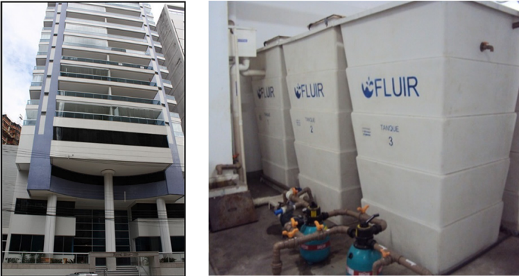
Figura 5.28 – Entrada principal e ETAC instalada no Edifício de alto padrão, cidade de Vitória, Espírito Santo, Brasil Fonte: acervo da Fluir Engenharia Ltda (2008)
