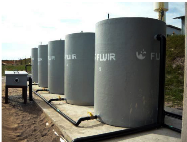
Figura 5.11 – Estação de tratamento de um condomínio residencial dotada de um RAC (os três primeiros tanques da foto) seguido de um filtro biológico aerado submerso (tanque de aeração e decantador secundário)
