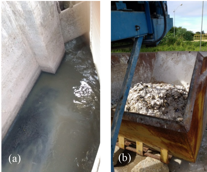
Figura 4.5 – (a) Acúmulo de sólidos antes do canal de desarenação; e (b) Manejo do material removido na etapa de gradeamento
