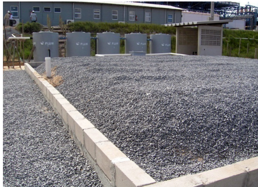
Figura 5.16 – Estação de produção de água de reúso a partir do esgoto da área administrativa de uma empresa, composta pela associação em série de um RAC e um FBAS (ao fundo) e um filtro de areia de fluxo vertical com enchimento de brita e areia
