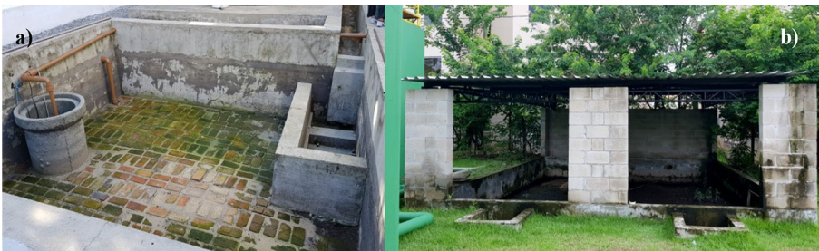
Figura 6.8 – Leitos de secagem convencionais para de desaguamento de lodo[(a) descoberto e (b) coberto] implantados em ETED de empreendimento habitacional em Maceió (AL) e em Ananindeua (PA)
