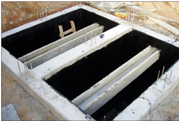
Figura 4.12 – Filtro anaeróbio em concreto moldado in loco
