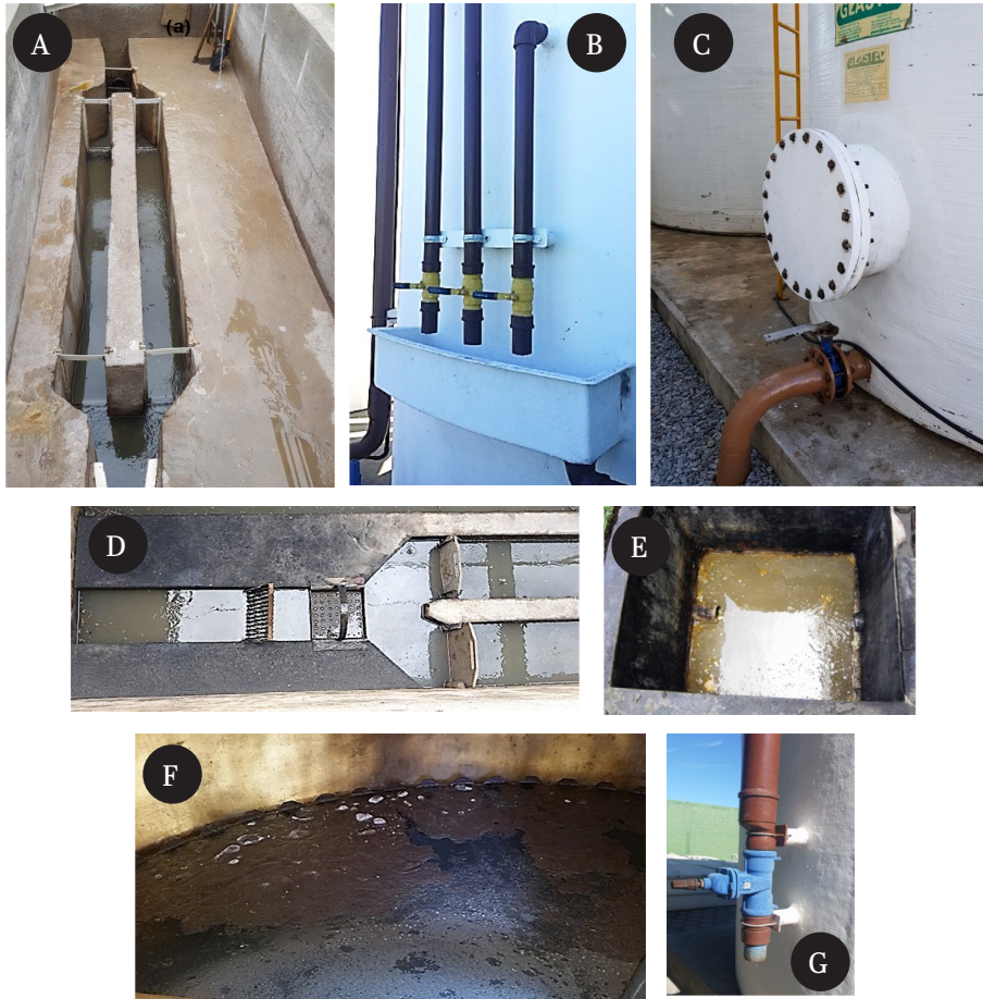
Figura 6.16 – Registro fotográfico de unidades e de instalações relacionadas ao gerenciamento de subproduto sólido de ETED implantadas em empreendimentos habitacionais (a. Desarenador tipo canal com duas câmaras com impermeabilização e remoção manual da areia; b. Tubulação de amostragem do compartimento de digestão do reator UASB; c. Tubulação de descarga de lodo de excesso de UASB e tampa de inspeção do compartimento de digestão; d. Unidade de gradeamento, cesto de retenção de sólidos grosseiros e stop-log para controle da vazão no desarenador; e. Caixa retenção de gordura em empreendimento habitacional; f. Formação de espuma em reator UASB tratando esgoto de empreendimento habitacional e g. Tubulação para descarte de espuma)
