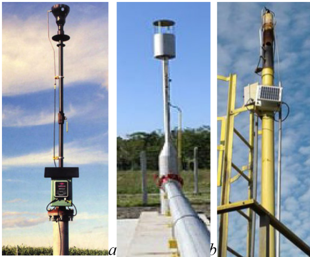
Figura 7.4 – Fotos de queimadores abertos de biogás Fonte: a) BAUKAL (2013); b) FOKAL (2018); c) RIETOW (2016)
