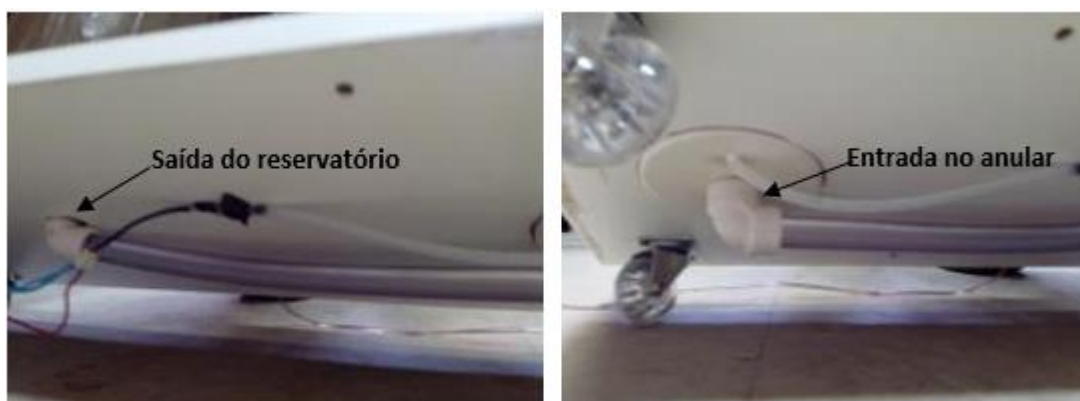
Figura 5.3-11. Tubulação na parte inferior da Base.
