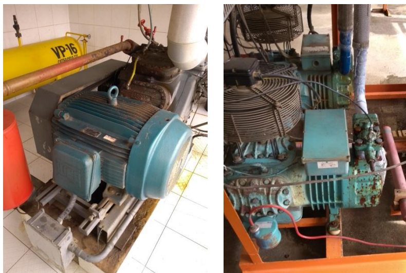
Figura 21 - Situação dos compressores do Sistema de Refrigeração.
