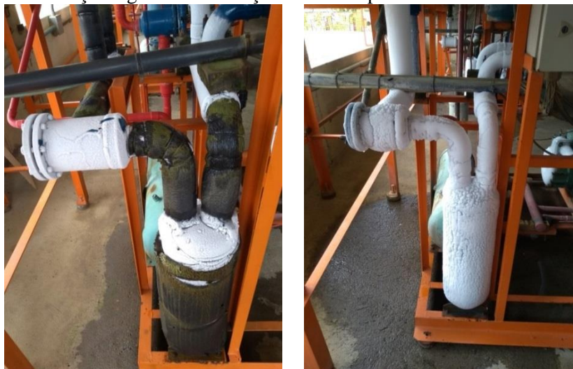
Figura 22 – Presença de gelo nas tubulações devido a precariedade dos isolamentos.
