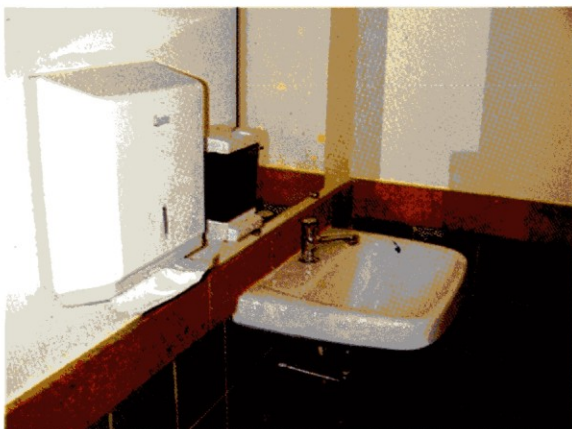
Foto 07. Lavatório com torneira de pressão com temporizador
