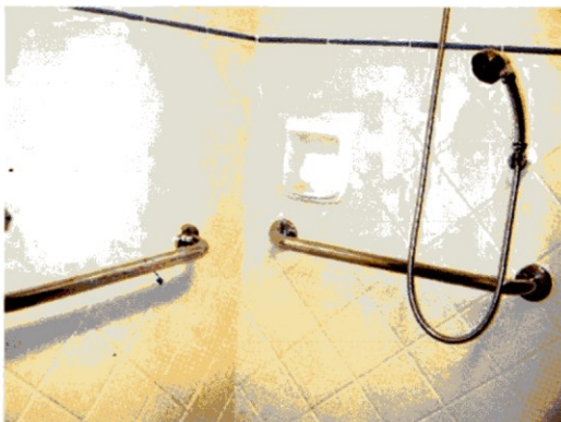
Foto 19. Barras de apoio no box do chuveiro
