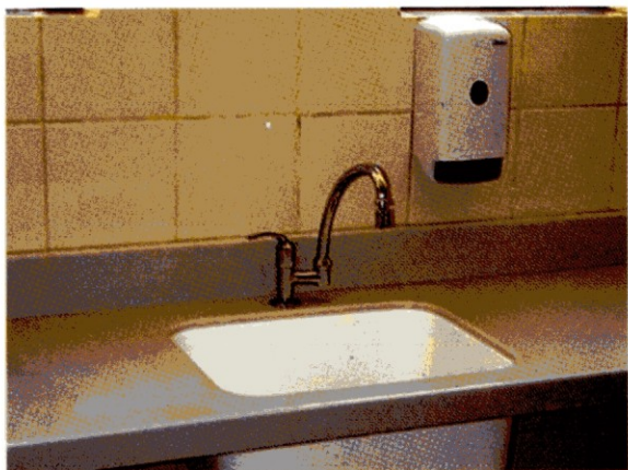
Foto 11. Pia de resina plástica integrada à bancada
