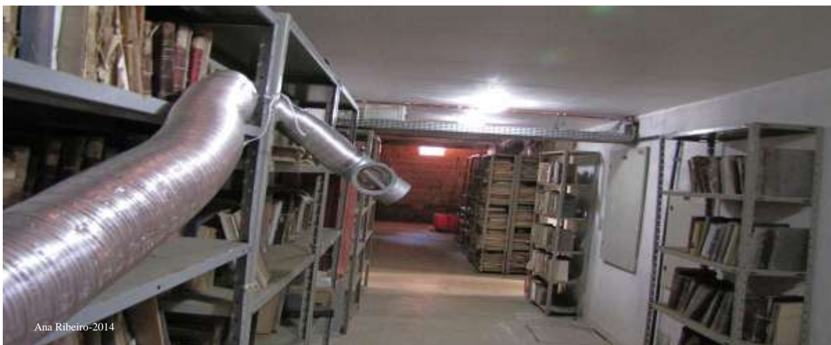
Figura 20 – Depósito de livros, com a mangueira sanfonada para realizar amostragem do ar interior.
