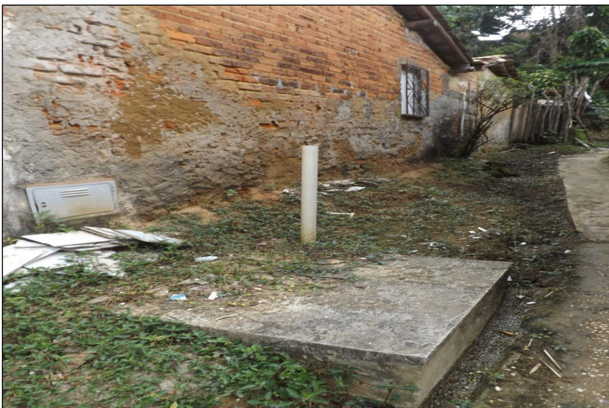
Figura 21 – Fossa séptica situada na Rua do Beco, Praia Grande, Ilha de Maré, Salvador-BA.
