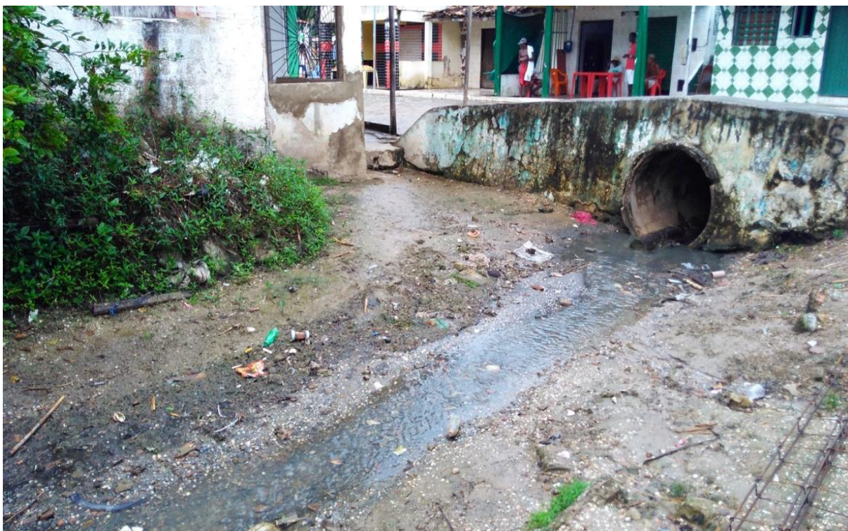
Figura 3 – Esgoto a céu aberto localizado na comunidade de Praia Grande, Ilha de Maré.
