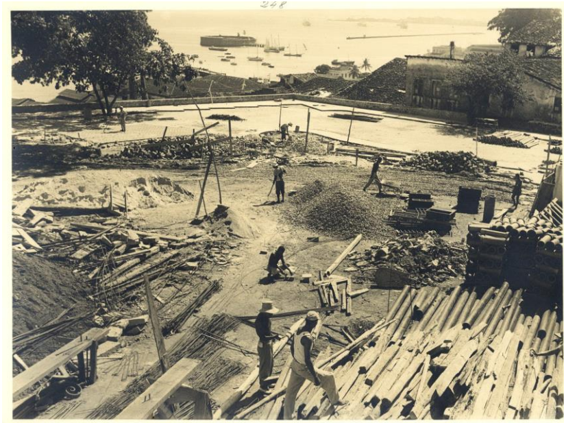
Figura 25. Construção do espaço ajardinado e estacionamento no Adro da Igreja. Fotografia, Jul. - Dez. 1958[?].
